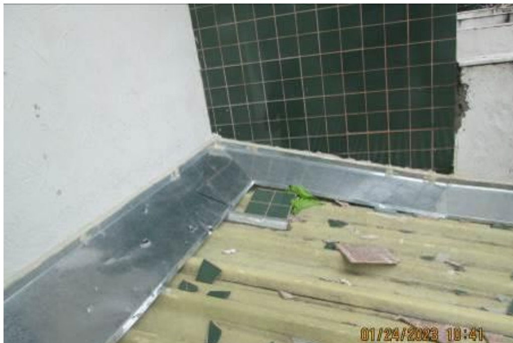
Figura 13 – Vista das peças cerâmica caídas em cima da cobertura, no 3º pavimento, risco à segurança e necessidade de reparo imediato.
