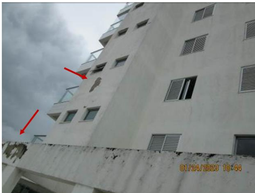
Figura 15 – Outra vista aproximada da fachada lateral direita – danos na pintura, relacionados à falta de manutenção preventiva.
