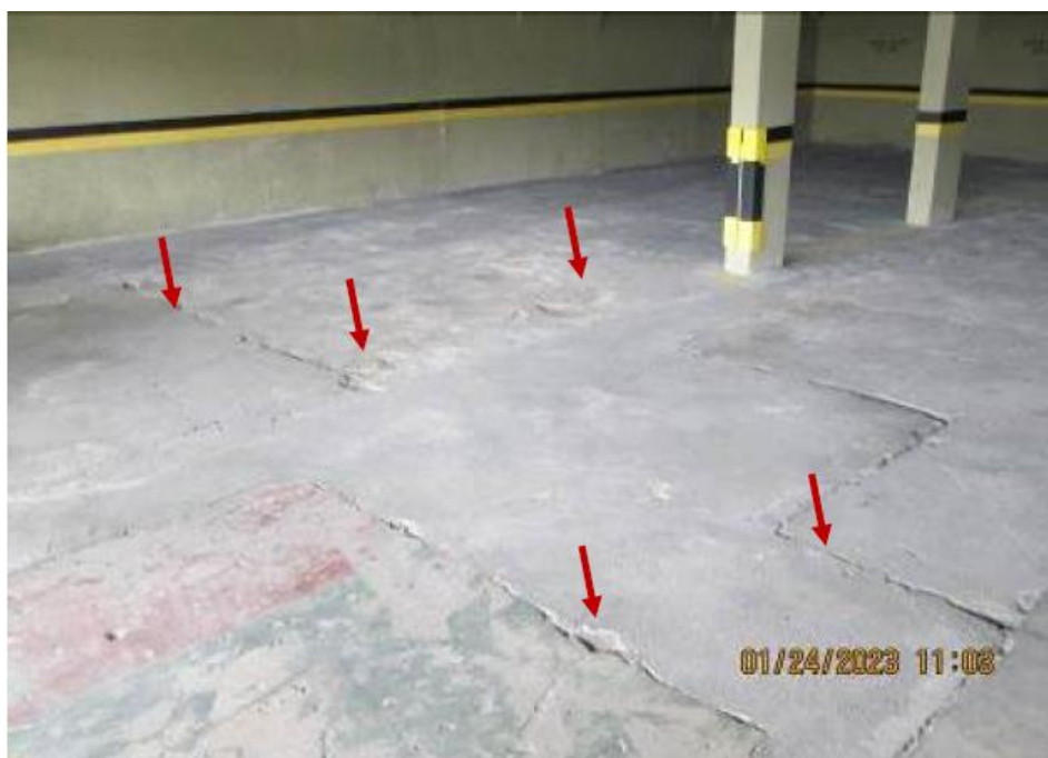
Figura 16 – Vista do piso da garagem com diversas marcas de reparos, trincas, trechos quebrados e rachaduras, reflexo de intervenções improvisadas.
