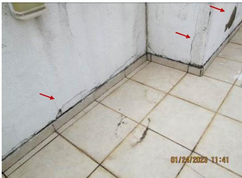
Figura 10 – Vista do deslocamento de pintura e trinca na parede do guarda corpo na cobertura do apto 701, deformação térmica e falta de manutenção.
