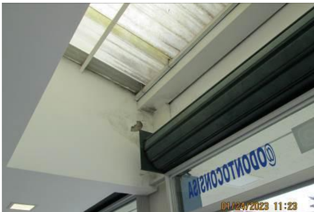
Figura 4 – Vista de marcas de infiltração pelo lado de dentro da loja de odontologia, reflexo de falta de manutenção e ou problemas de vedação.
