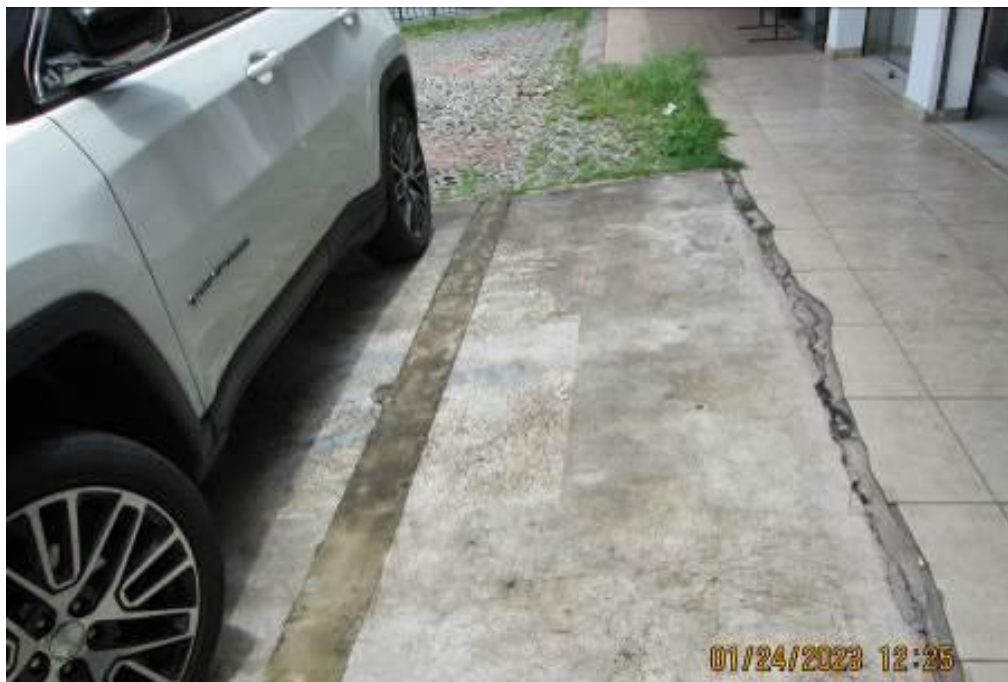
Figura 17 – Vista do piso do estacionamento externo do condomínio, com marcas de desgaste e falta de manutenção.
