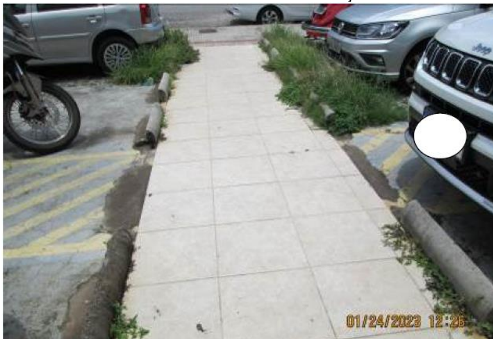
Figura 19 – Vista do piso da passarela interna do estacionamento externo do condomínio, piso irregular, falhas construtivas e falta de manutenção.
