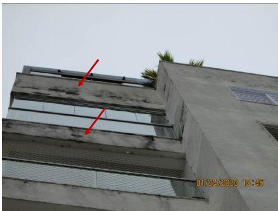
Figura 3 – Danos na pintura na fachada, indicando falhas na manutenção externa.
