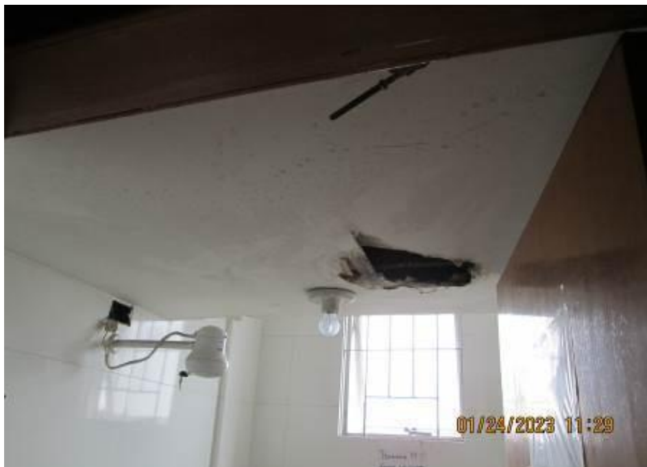
Figura 5 – Vista interna do banheiro da padaria, deslocamento de gesso do teto, evidenciando infiltração prolongada.
