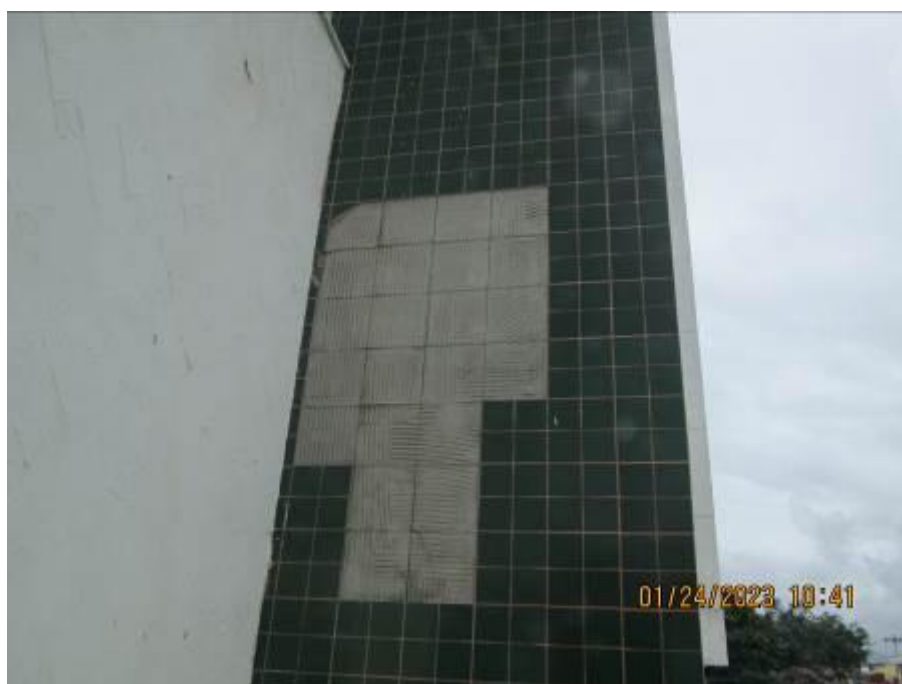
Figura 12 – Vista do deslocamento de cerâmica na fachada frontal, na altura do 3º pavimento, falha de adesão e vícios construtivos.
