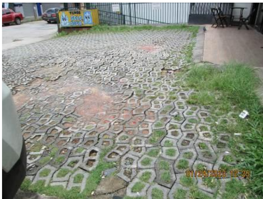
Figura 18 – Vista de diversos danos no piso do estacionamento externo do condomínio, comprometendo a funcionalidade e a segurança.
