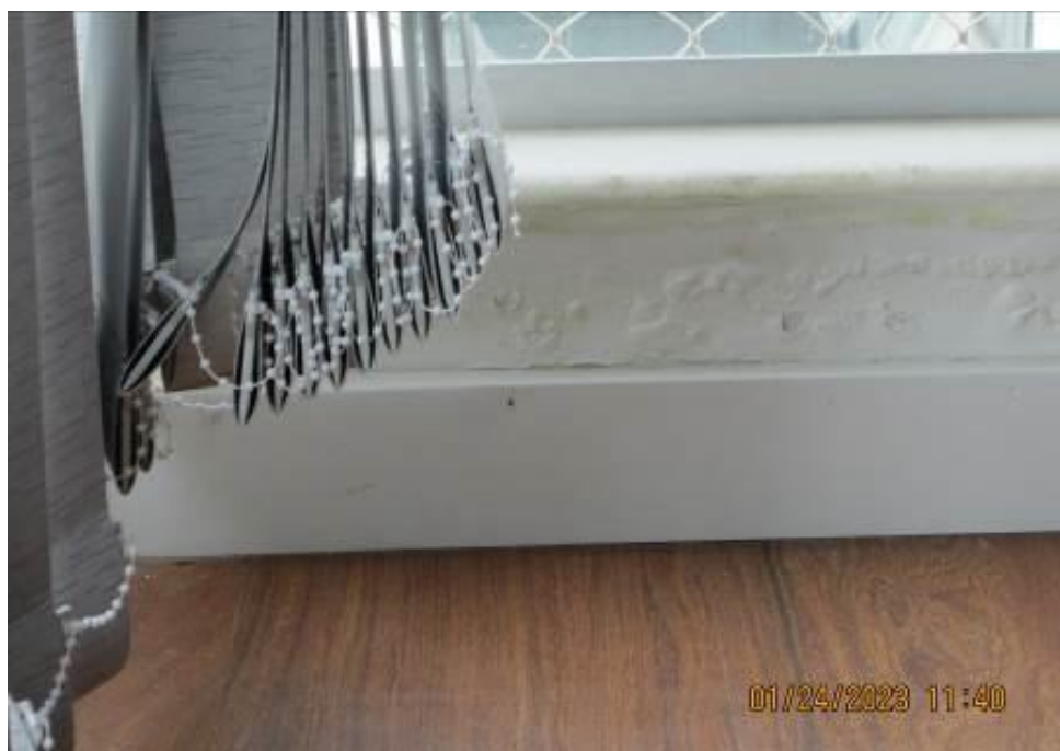
Figura 6 – Vista de bolhas na pintura abaixo da janela da sala do apto 701, sinalizando umidade recorrente.
