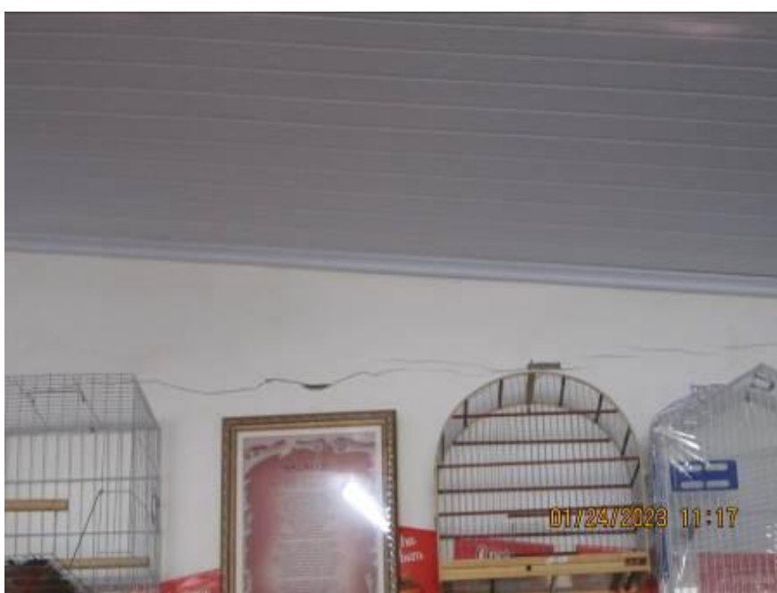
Figura 8 – Vista de trinca horizontal em viga da loja de ração, trinca de encontro de viga com revestimento, associada a movimentação do arcabouço estrutural.
