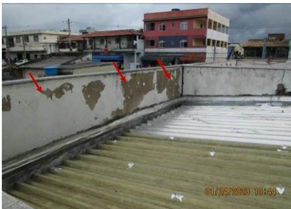
Figura 14 – Vista de deslocamento de pintura no muro na área externa (3º pavimento/salão de festas), reflexo de exposição às intempéries.
