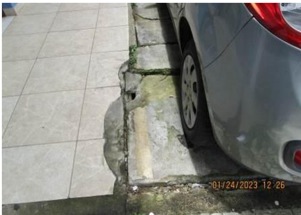
Figura 20 – Vista de trecho de piso quebrado no estacionamento externo do condomínio, demonstrando a necessidade de reparo.
