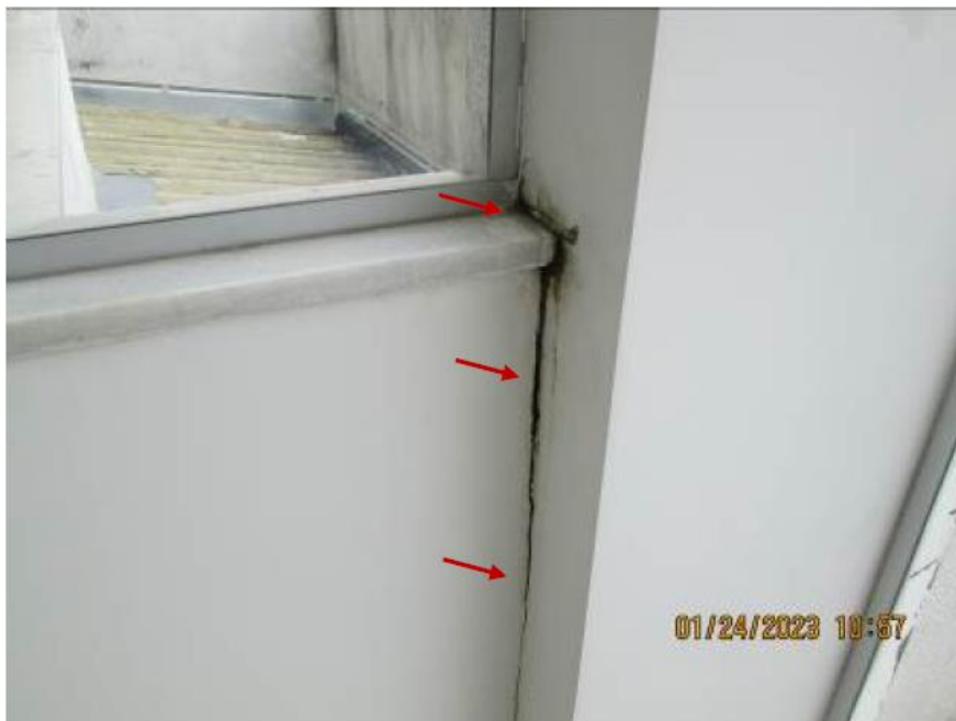
Figura 7 – Vista de manchas de umidade no hall dos elevadores do 7º andar, reflexo de falhas de impermeabilização.
