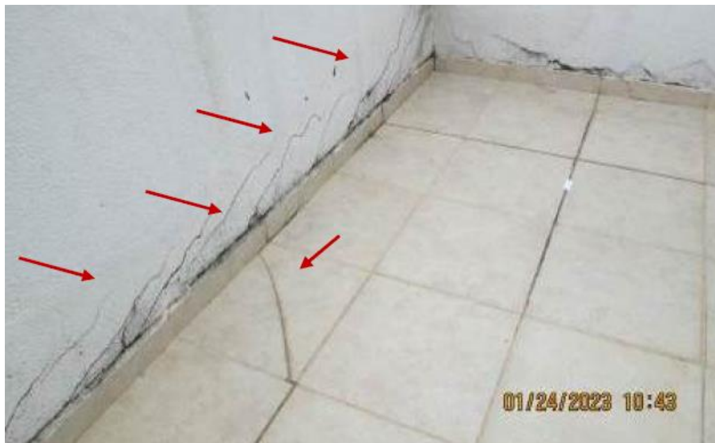
Figura 11 – Vista de trincas no piso cerâmico e parede lateral (3º pavimento/salão de festas), indicando movimentações e falhas de manutenção.
