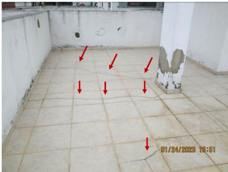
Figura 9 – Vista de trincas no piso cerâmico em torno de pilar (3º pavimento/salão de festas), evidenciando recalques diferenciais.
