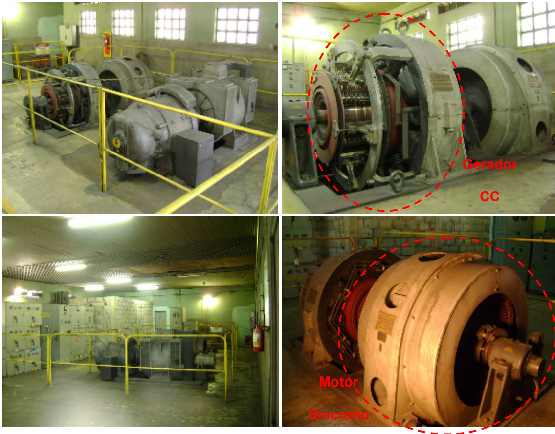
Figura 4.7 - Motor síncrono e gerador de corrente contínua na subestação 02.
