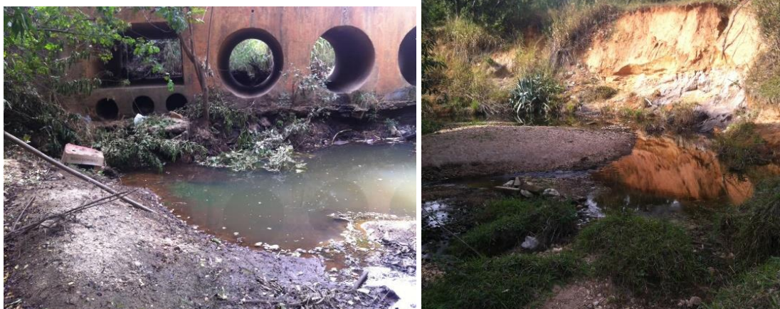
Figuras 63 e 64: Deterioração ambiental do Ribeirão Soberbo. Fonte: INOT disponível em: https://bit.ly/2WfmY85 - acesso 20/04/2019
