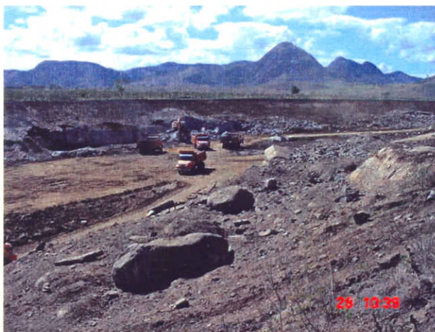
Figura 12: Construção do Canal de adução ao redor da Pedra Lorena em Aimorés, Minas Gerais, 2004.
