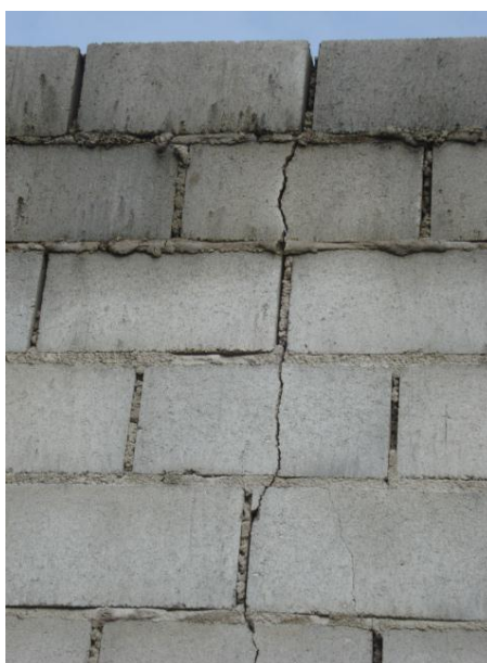
Figura 13: Trinca no muro de divisa Fonte:O autor (2010).
