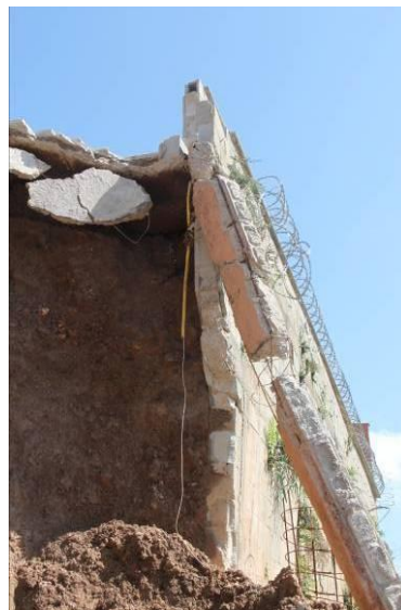
Figura 40: Detalhe da inexistência de armação na alvenaria do muro Fonte: Parecer técnico – SARDINHA (2010)
