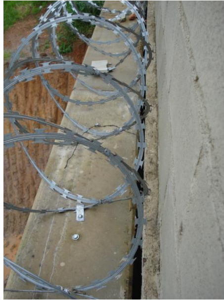
Figura 16: Dilatação entre as estruturas existentes Fonte:O autor (2010).
