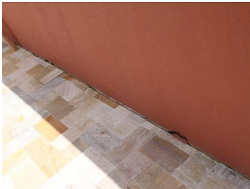
Figura 45: Detalhe da fissura no pé do muro Fonte: Parecer técnico – SARDINHA (2010)
