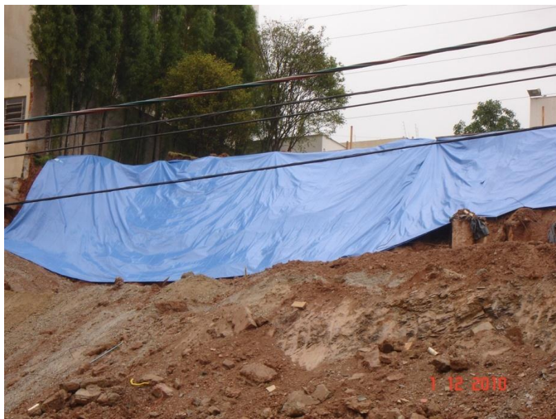
Figura 36: Proteção do talude Fonte:O autor (2010)
