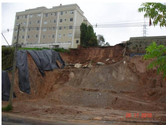
Figura 25: Ruptura do talude e muro de contenção Fonte: O autor (2010)
