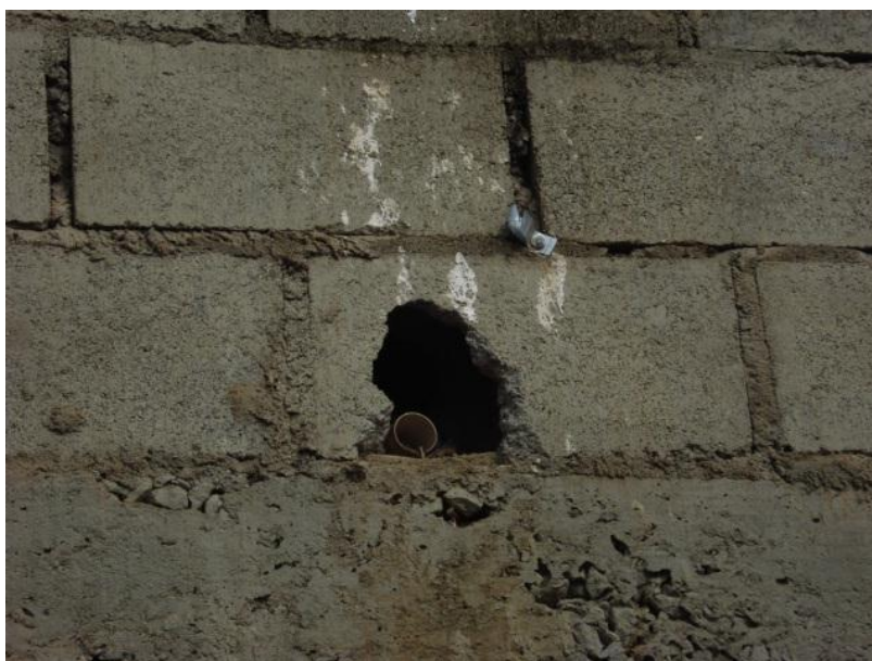
Figura 15: Drenagem má executada Fonte:O autor (2010).
