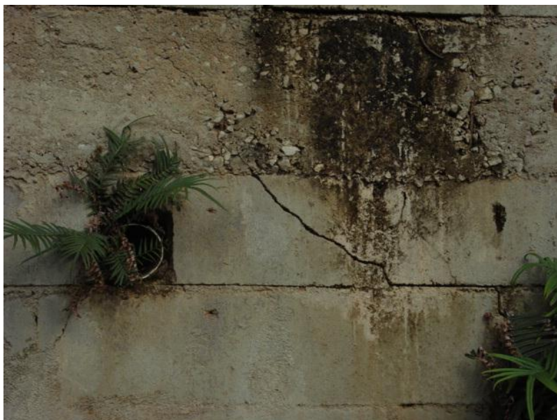
Figura 14: Drenagem obstruída Fonte:O autor (2010).
