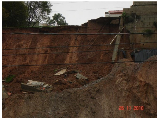
Figura 27: Ruptura da estrutura de contenção Fonte:O autor (2010)
