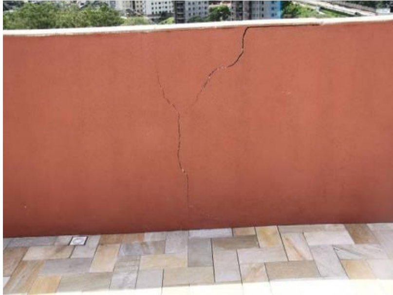
Figura 43: Detalhe do ralo junto ao muro e fissuras. Fonte: Parecer técnico – SARDINHA (2010)
