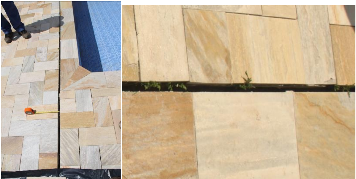
Figura 44: Detalhe junta próximo à piscina Fonte: Parecer técnico – SARDINHA (2010)
