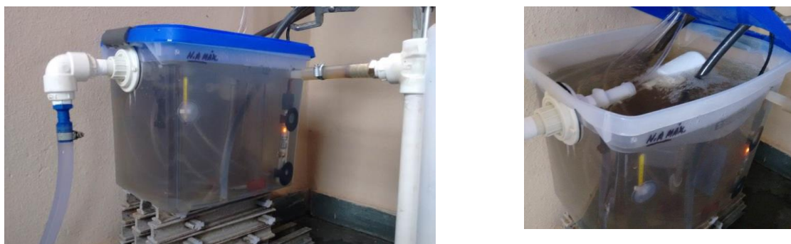
Figura 7.15 – Câmara de aeração com termostato e boia de nível.
