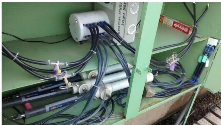
Figura 6.11. Interior do abrigo da bomba peristáltica, detalhe das células de fluxo e sondas multiparâmetros YSI 600 XLM.
