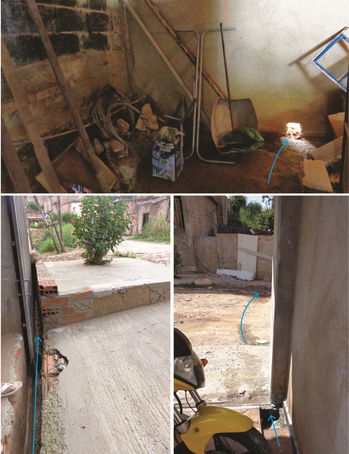
Fotografia 5: Estratégias para escoamento de água pluvial
