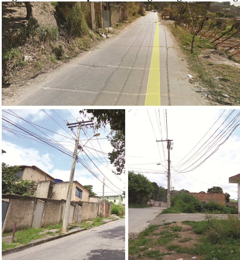
Imagem 10: Marcas no asfalto da rua Augusta Sacchetto Scalzo nos pontos onde os ‘gatos’ de água foram feitos e postes da Cemig com ‘gatos’ de energia elétrica
