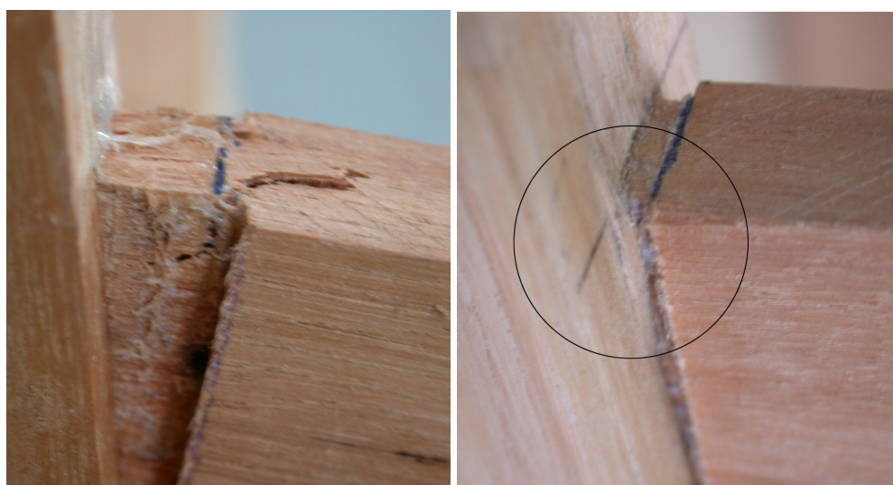
Figura 4.16 Ruptura da travessa e ruptura no lado superior do montante em ligações espigadas
