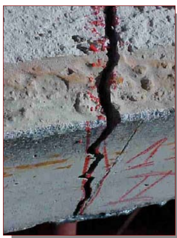
(c) Abertura da fissura
