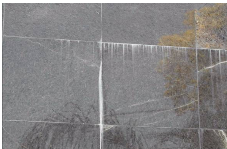
Figura VII.4: Eflorescências devido à presença de sais provenientes de argamassa, em fachada revestida com sienite Café Imperial
