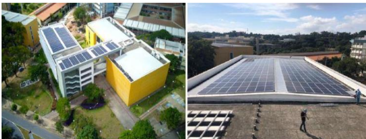
Figura 5.1. CAD3 e usina fotovoltaica no telhado
