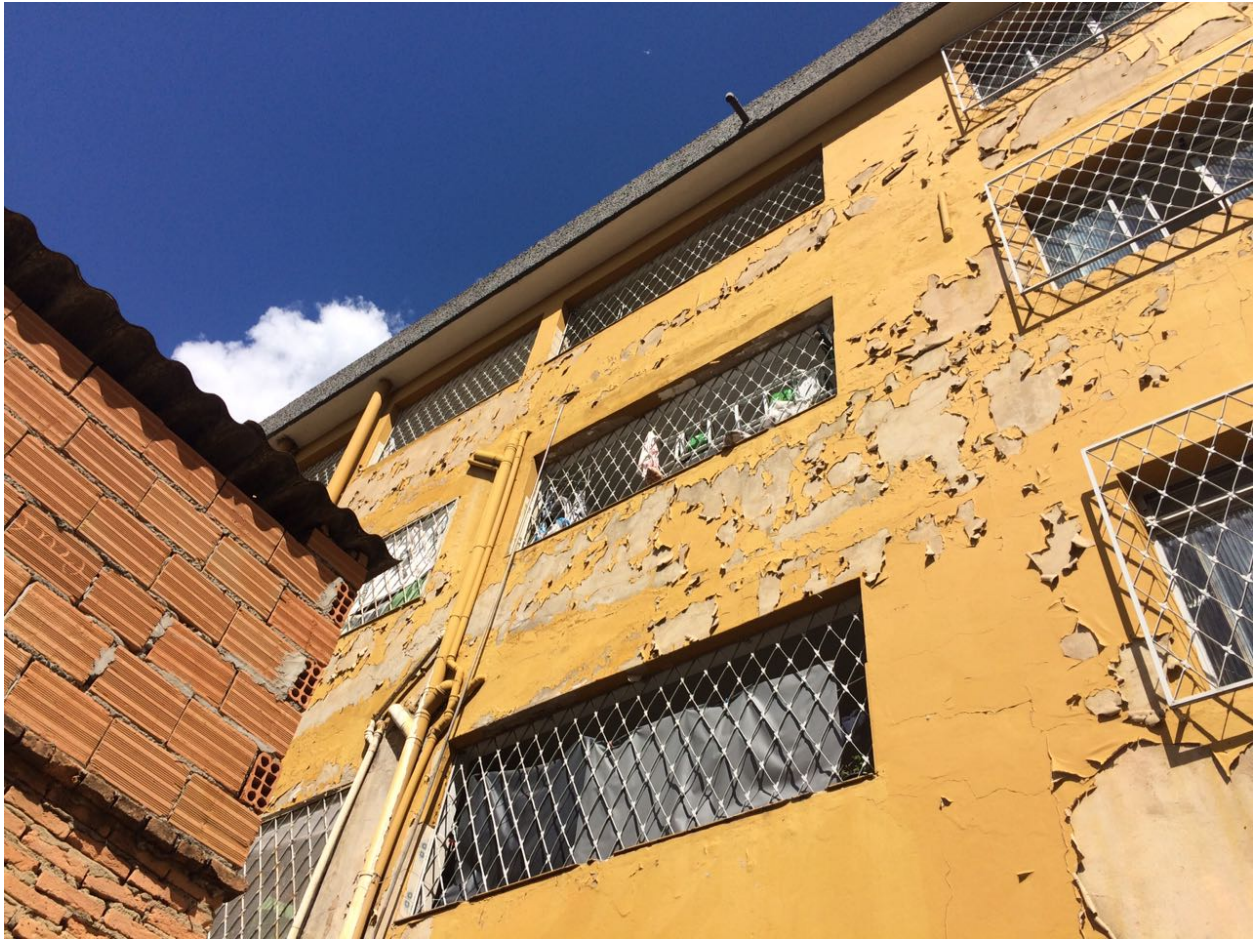
Figura 22 – Descamação da pintura externa (acervo do autor).
