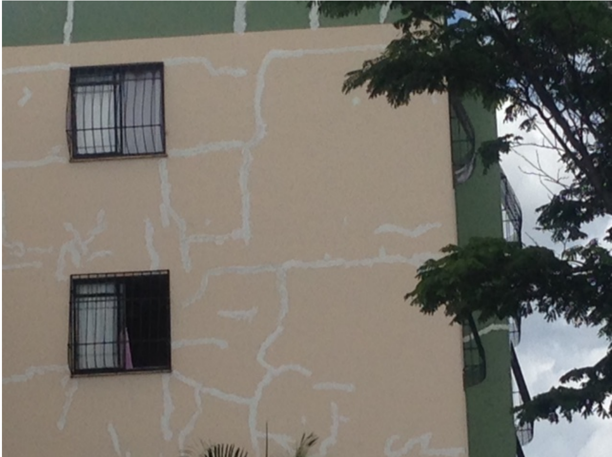
Figura 26 – Trincas e fissuras na fachada externa da edificação por outro ângulo (acervo do autor).
