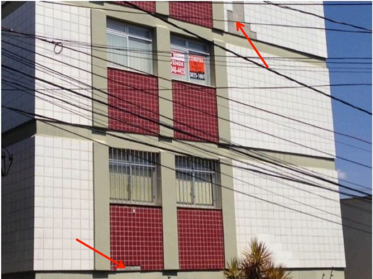
Figura 18 – Deslocamento cerâmico (acervo do autor).
