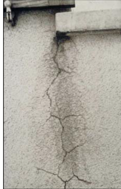
Figura 13 – O fluxo de água interceptado do peitoril da janela escorre lateralmente, provocando a fadiga do reboco desenvolvendo sua fissuração (THOMAZ,1992).
