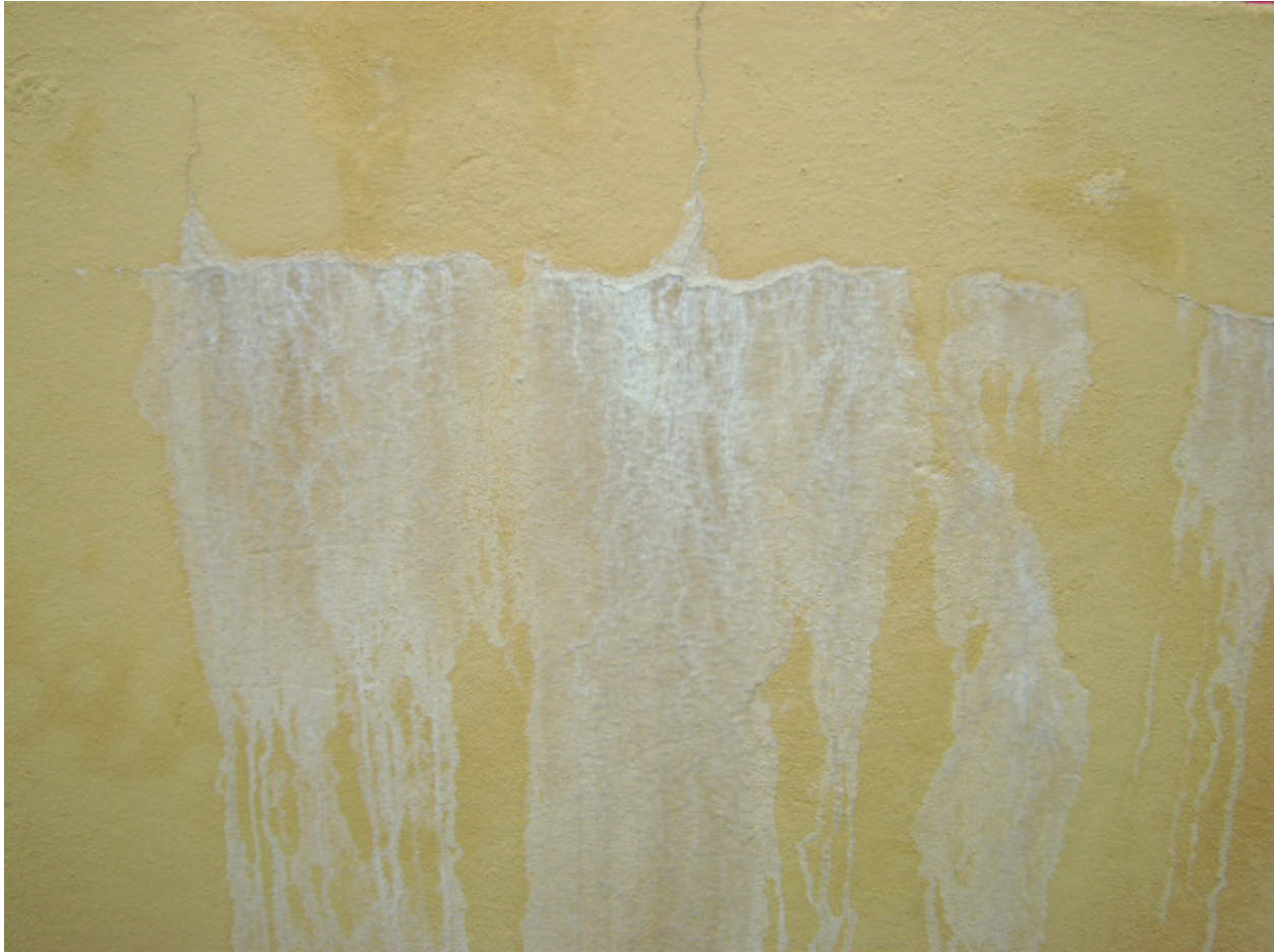
Figura 8 – Eflorescência, cristalização dos sais solúveis na superfície da argamassa de revestimento (Ferreira, 2010).
