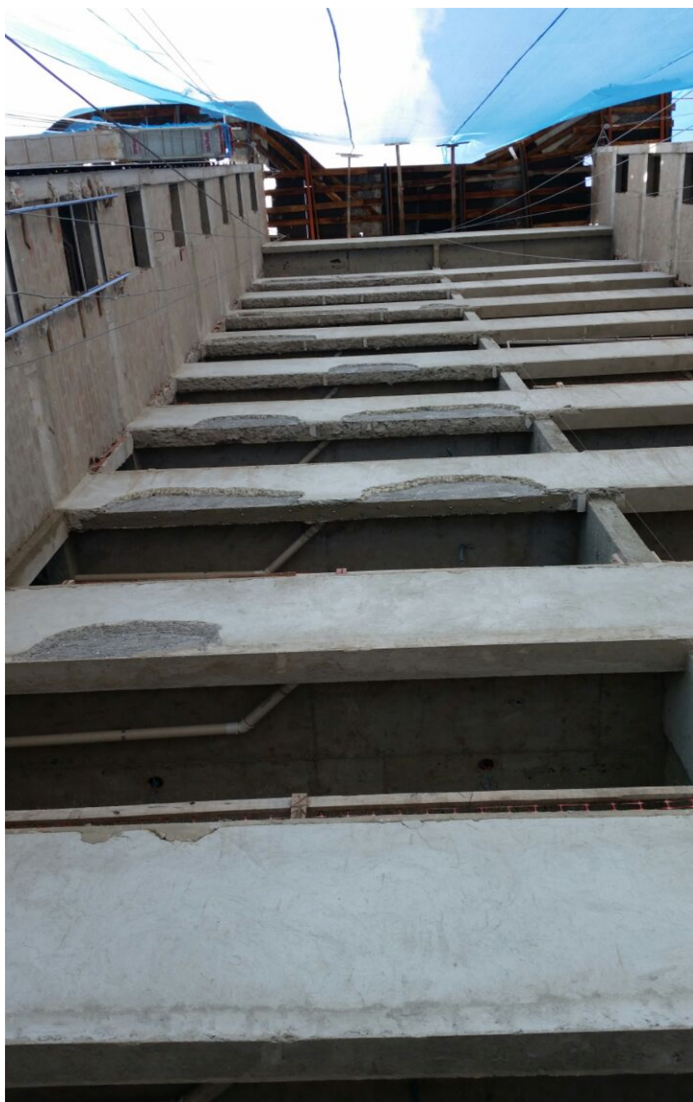
Figura 20 – Deslocamento da argamassa de reboco (acervo do autor).
