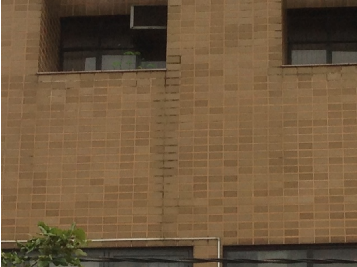
Figura 24 - Detalhe da deterioração das juntas (acervo do autor).
