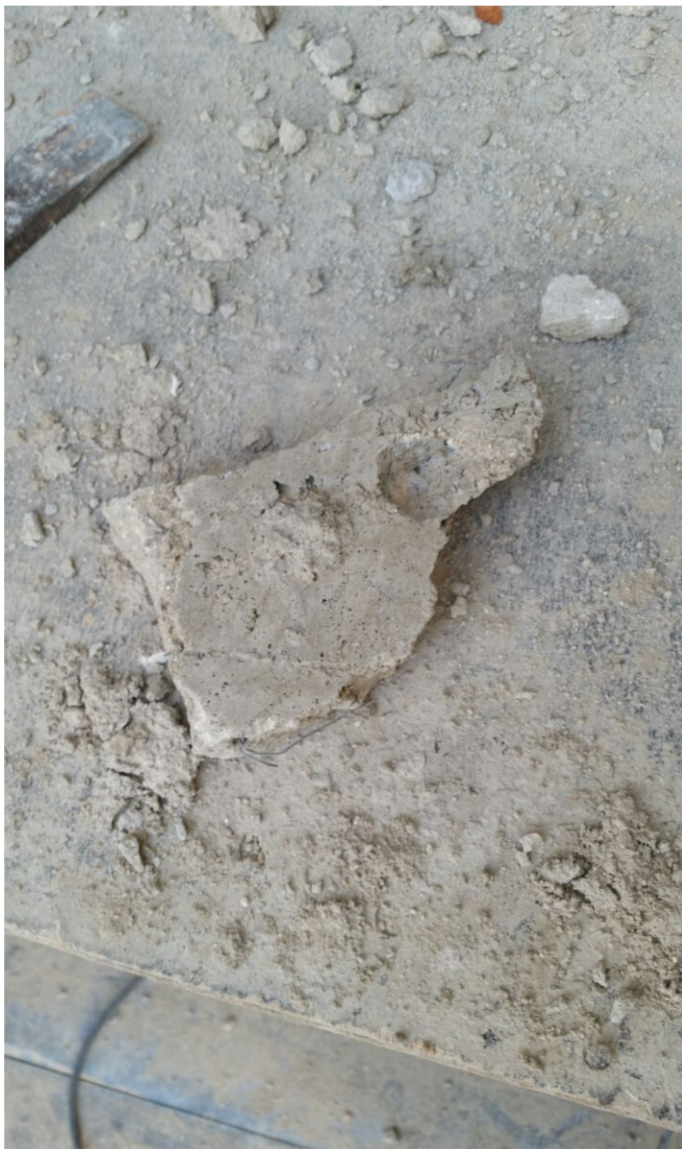
Figura 21 – Detalhe da argamassa de reboco deslocada (acervo do autor).
