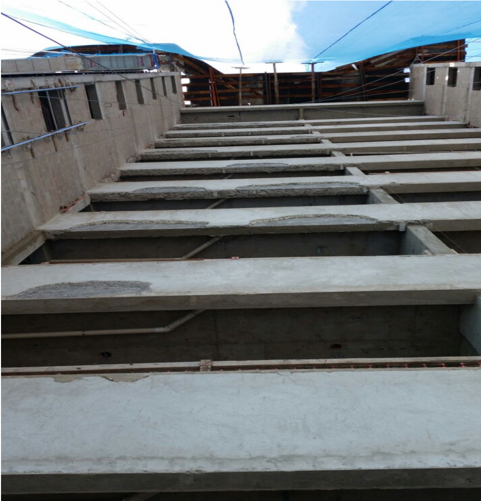
Figura 7 – Descolamento do revestimento argamassado em placas devido a ausência da tela soldada para fachada na interface entre estrutura e alvenaria (edificação III dos estudos de casos).
