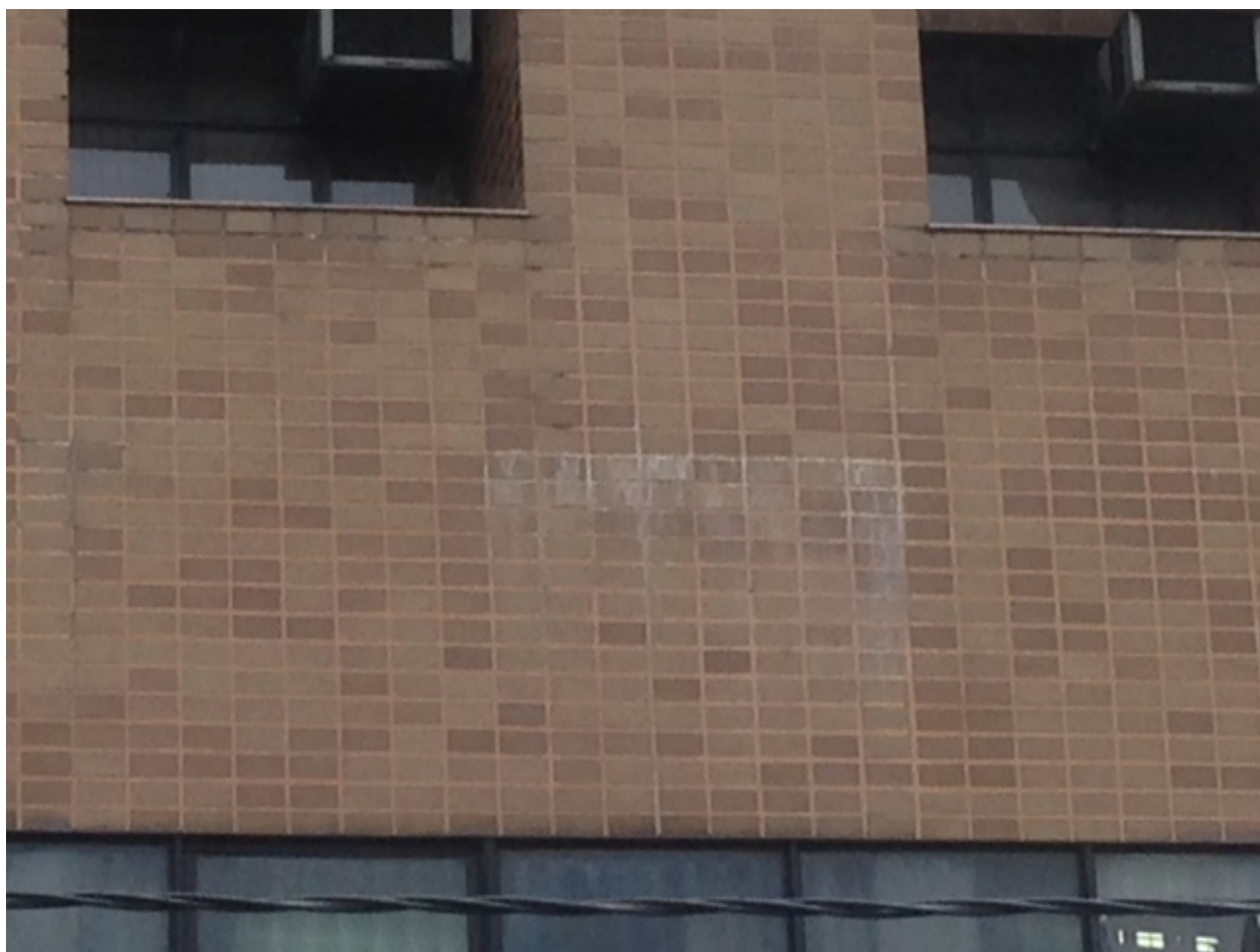
Figura 23 – Detalhe da eflorescência em revestimento cerâmico (acervo do autor).
