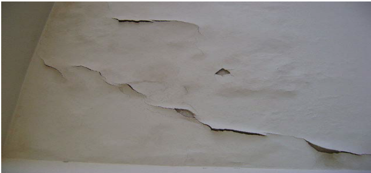
Figura 9 - Desagregação com descolamento do revestimento devido a infiltração de água na fachada (Ferreira, 2010).
