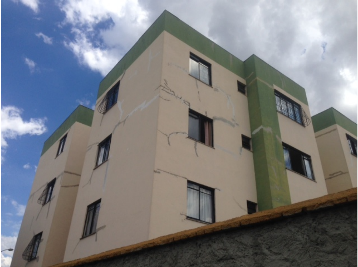
Figura 25 – Trincas e fissuras na fachada externa da edificação (acervo do autor).
