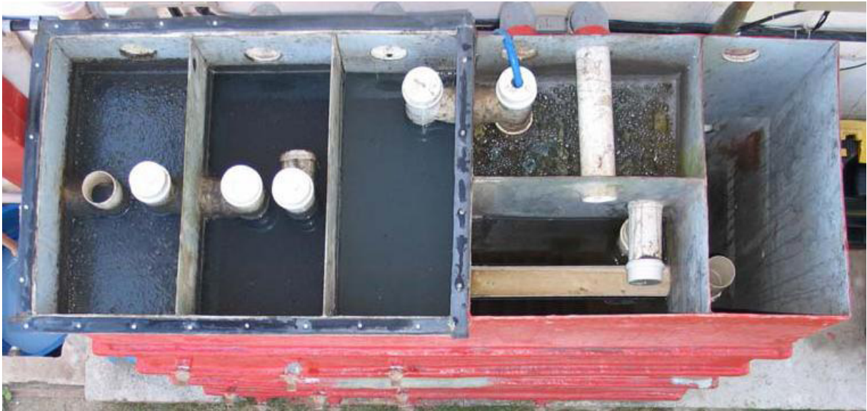
Figura 3.3.3: Vista superior de uma estação de tratamento para águas cinzas
