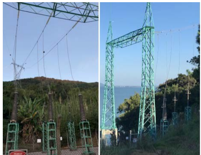
Figura 6. Transição Híbrida da LT 230kV Biguaçu – Desterro (aérea-subaquática) de propriedade da Eletrosul
