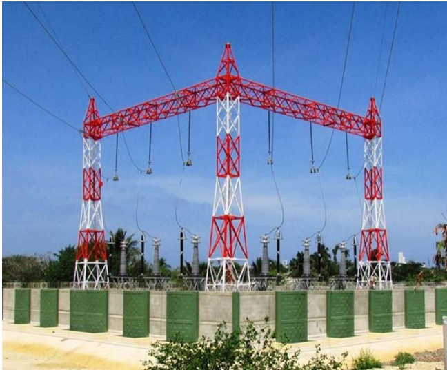
Figura 7. Transição Híbrida em Cartagena Colômbia 220kV (aérea-subterrânea) de propriedade da ISA
