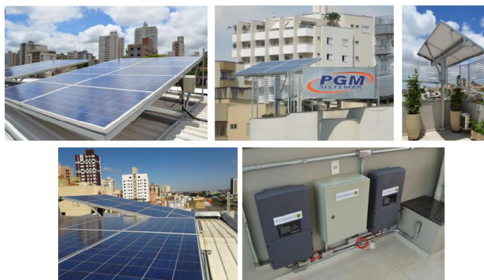
Figura 5.4 –UFV PGM (Uberlândia, MG) 6,58 kWp. Fonte: Buiatti (2013).
