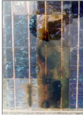
Figura 1.16 - Célula solar de módulo fotovoltaico queimada. Fonte: Ndiaye et al. (2013).
