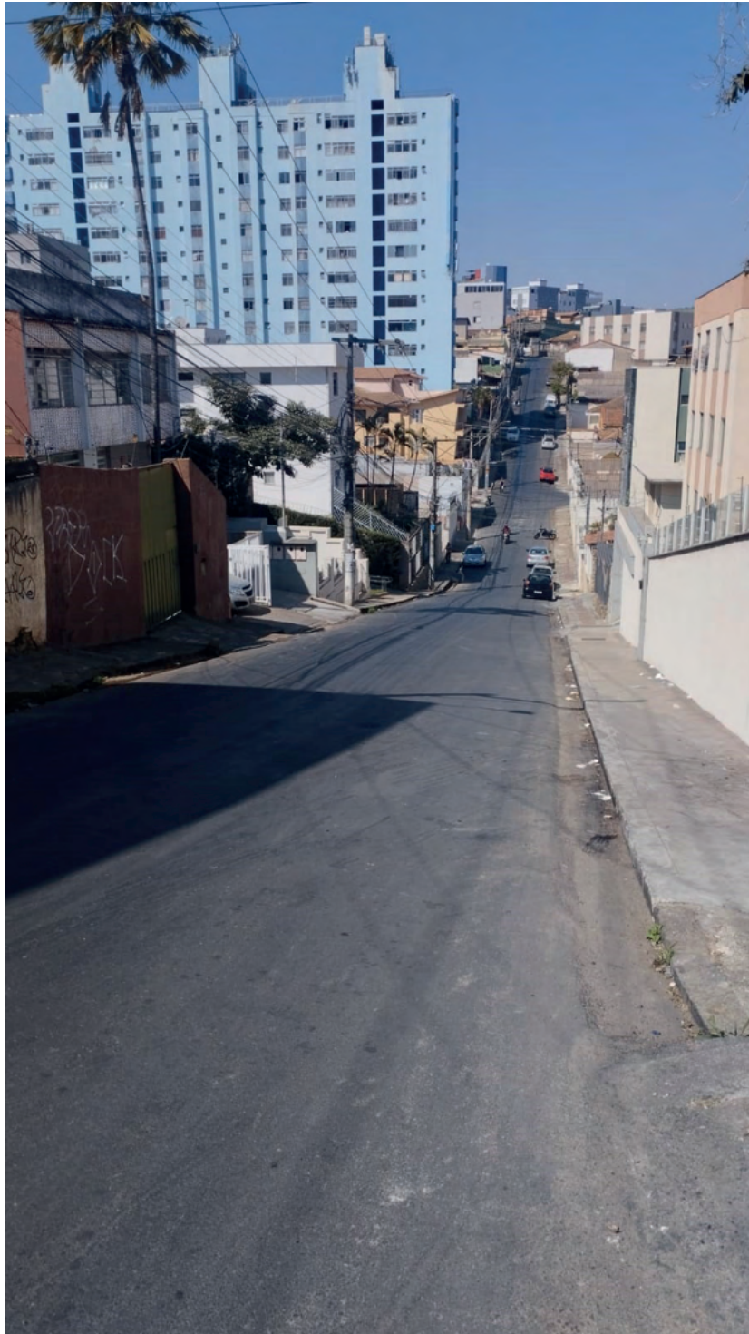
Fig. 46 - Registro após processos de recapeamento da Rua Itabira, Julia Bernardes, Belo Horizonte, 2024-2025.
