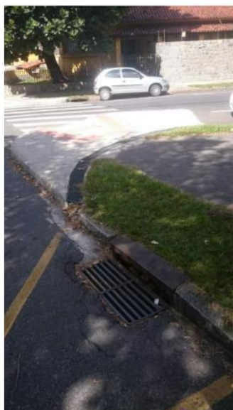
Imagem 12: Dispositivo de desvio de água de chuva. Falta de sarjeta na pista. Rua Josafá Belo, Cidade Jardim. Fonte: Acervo do autor.
