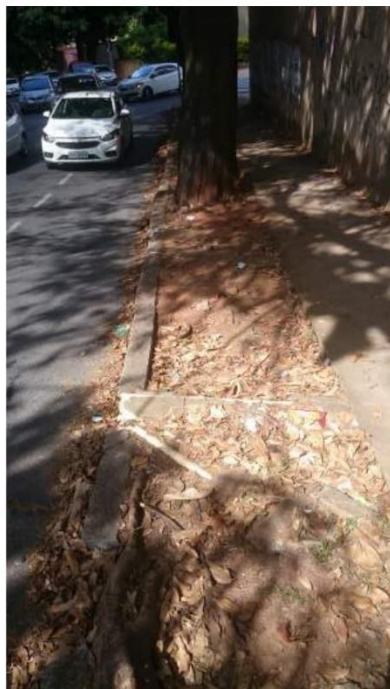
Imagem 10: Contribuição dos lotes desembocando nas vias com encanação exposta em meio a muitas folhas, evidenciando precariedade. Falta de calha na pista. Rua Josafá Belo, Cidade Jardim. Fonte: Acervo do autor.
