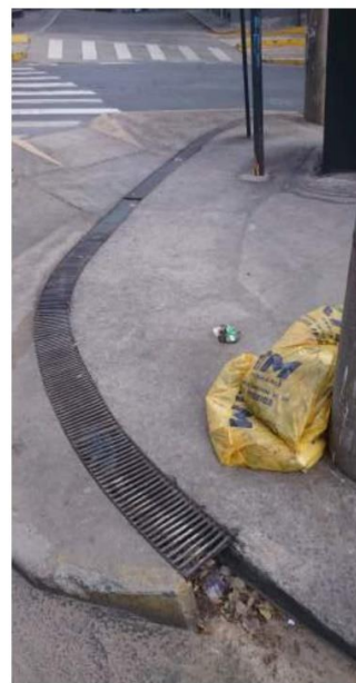
Imagem 19: Dispositivo de desvio de chuva obstruído com lixo trazido pela chuva. Avenida do Contorno, Santo Antônio. Fonte: Acervo do autor.
