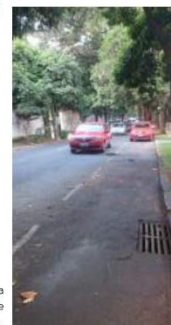
Imagem 11: Falta de sarjeta na pista. Rua Josafá Belo, Cidade Jardim. Fonte: Acervo do autor.
