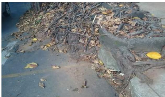
Imagem 12: Falta de solução condizente entre a árvore centenária, via e a água de chuva. As folhas seguem a jusante prejudicando o sistema que também carece de manutenção. Rua Josafá Belo, Cidade Jardim. Fonte: Acervo do autor.
