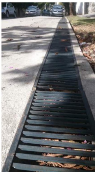
Imagem 13: Dispositivo de desvio de água de chuva obstruído com folhas. Falta de sarjeta na pista. Rua Josafá Belo, Cidade Jardim. Fonte: Acervo do autor.
