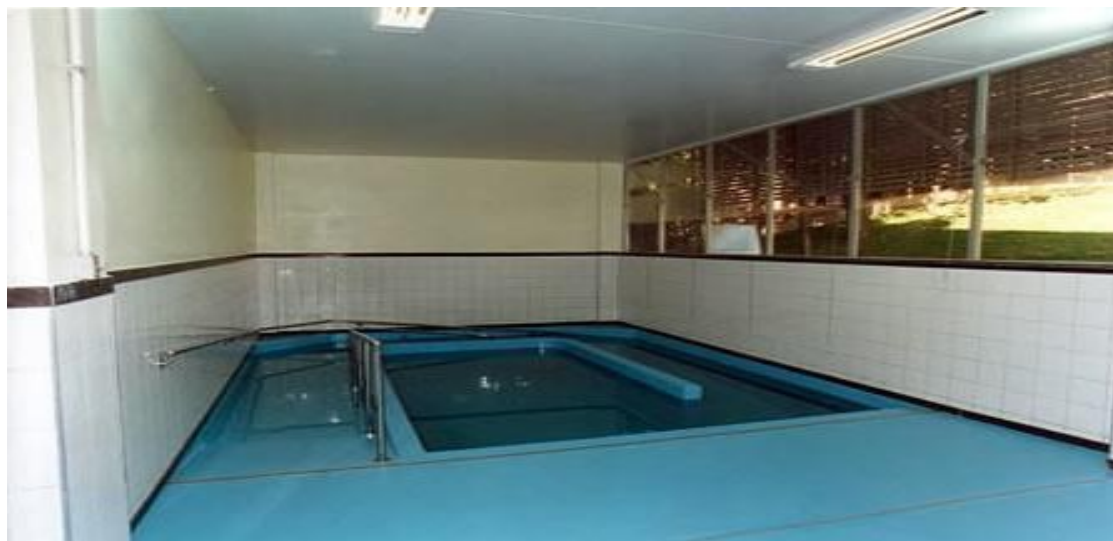
Figura 9 – Piscina terapêutica antes da obra
