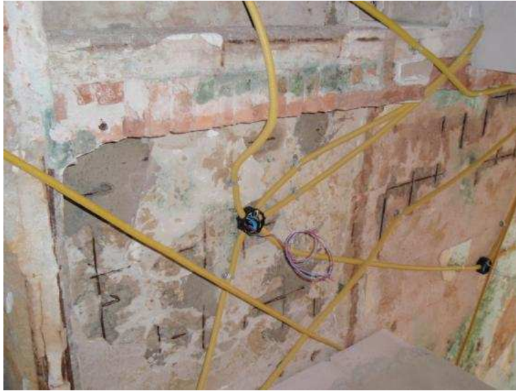
Figura 120 – Ferragem tomada pela ferrugem em vigas laje do Ed. Tabajara. 2011.
