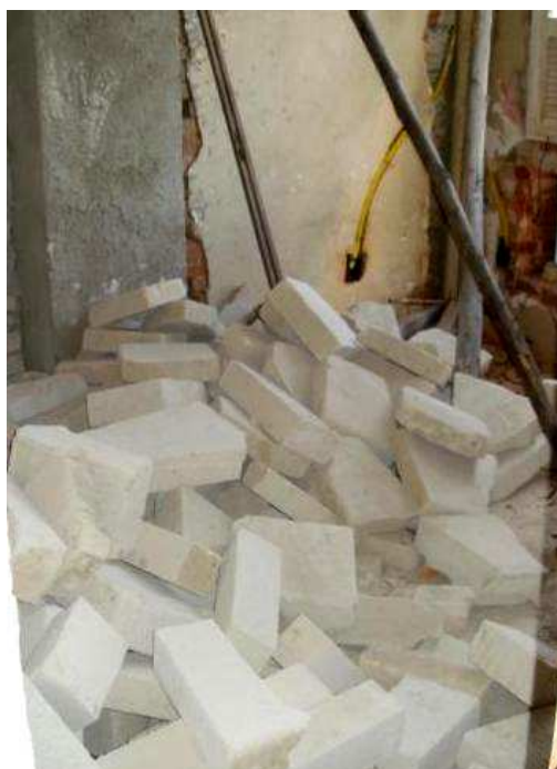
Figura 132 – Sobras de bloco de concreto celular devido aos cortes necessários para adequá-los às dimensões dos vãos. 2011.
