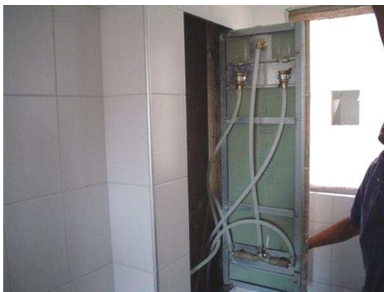
Figura 14 - Instalações hidráulicas em tubos flexíveis do tipo PEX. Shaft para passagem e manutenção do sistema. Fonte: http://banheiropronto.com.br/ . Acessado em: 16/11/2011.
