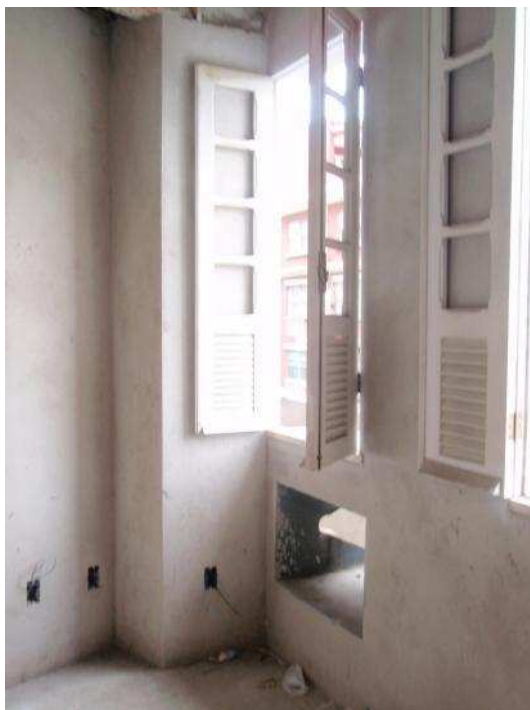
Figura 126 - Edifício Pouso Real. Caixa para futura instalação de aparelho de ar condicionado. Instalado abaixo da esquadria. 2011.
