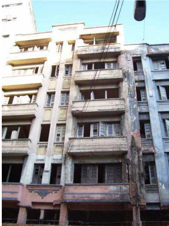
Figura 75 - Estado de conservação do Ed. Tabajara antes da reabilitação. 2006. Fonte: SEHAB/PMV.
