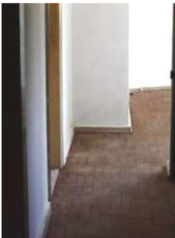
Figura 28 – Piso revestido em tacos de madeira. Edifício Estoril. 2008. Fonte: SEHAB/PMV.
