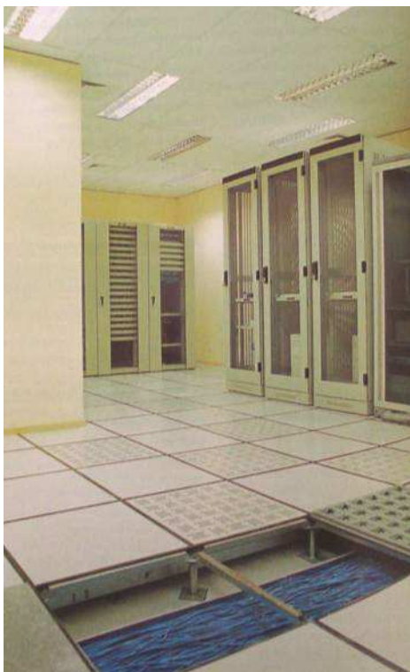
Figura 12 - Piso elevado. Passagem de cabeamento do sistema de dados. Fonte: TÉCHNE, 2004.
