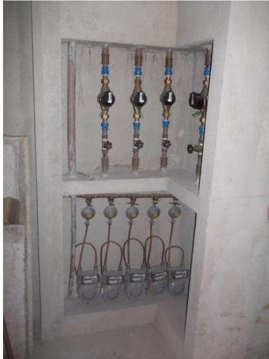
Figura 133 - Shaft para passagem das instalações prediais. Medidores de água e gás em um dos pavimentos do Edifício Pouso Real. 2011.
