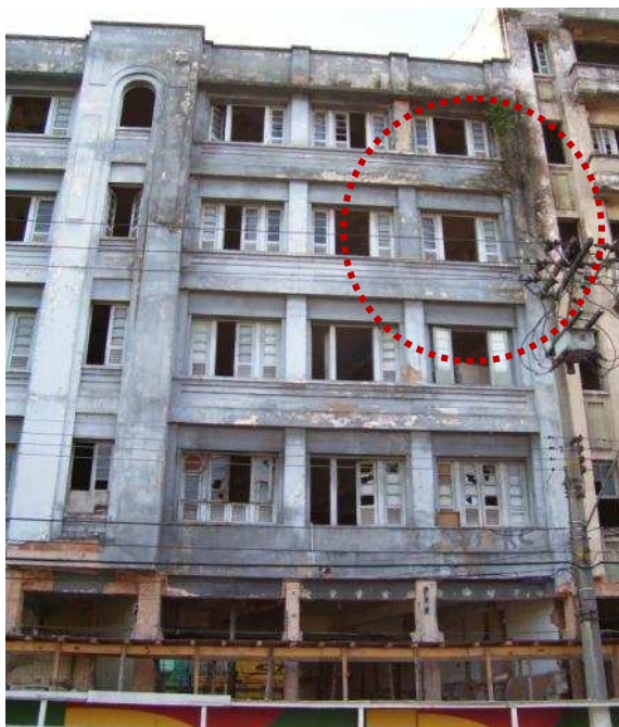
Figura 56 - Fachada do Ed. Pouso Real (av. Getúlio Vargas). No encontro com o edifício vizinho (Ed. Tabajara,) observa-se uma proliferação de bolor e presença de vegetação em decorrência do excesso de umidade na alvenaria. 2006. Fonte: SEHAB/PMV.
