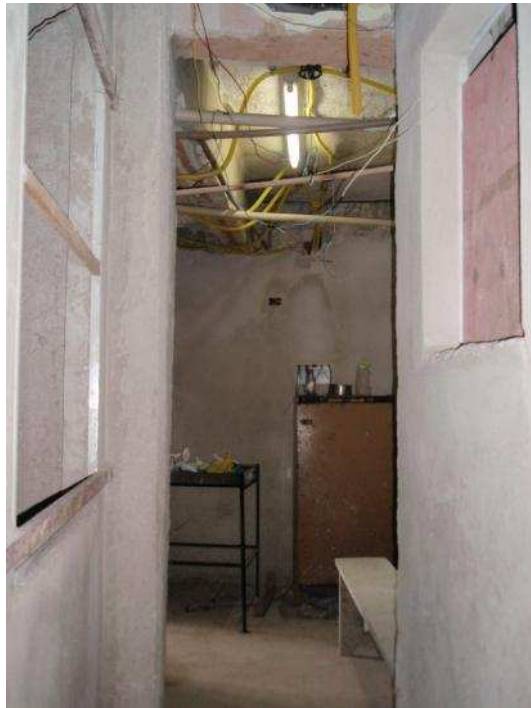
Figura 135 - Eletrodutos e tubulação hidrossanitária passando por baixo da laje. 2011.
