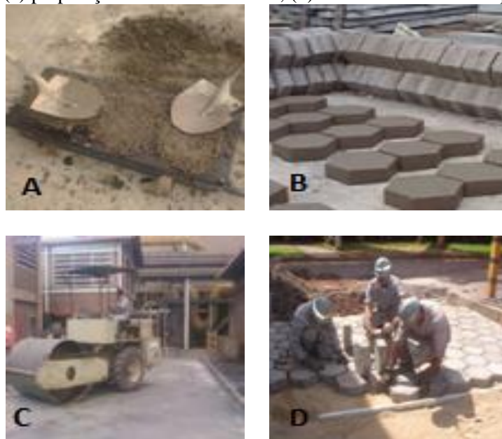
Figura 19- (a) fabricação dos bloquetes; (b) maturação dos bloquetes; (c) preparação de base e sub-base; (d) assentamento dos bloquetes
