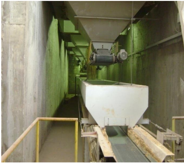
Figura 37 - Central dosadora e misturadora de agregados automática da Uni-stein
