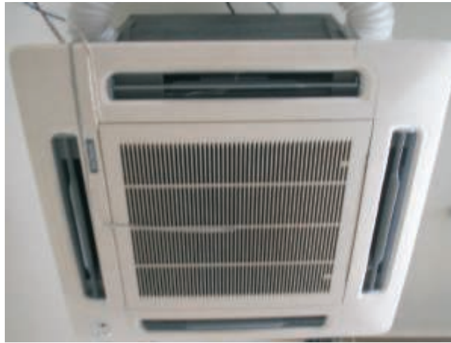
Figura 3.2: Unidade interna do condicionador de ar.
