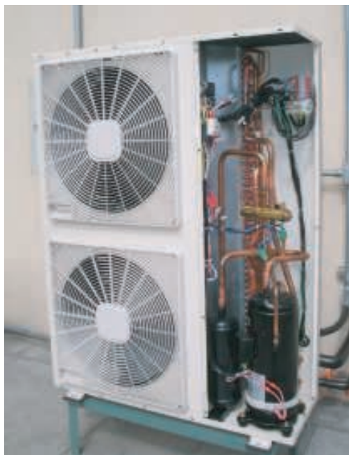
Figura 3.1: Unidade externa do condicionador de ar.
