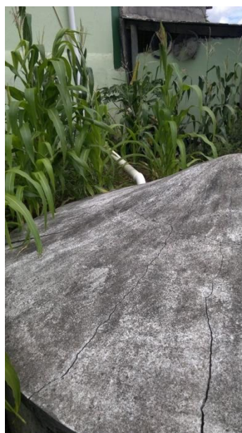
Figura 15. Sistema de captação de águas de chuva, danificado, na horta Jardim Produtivo.
