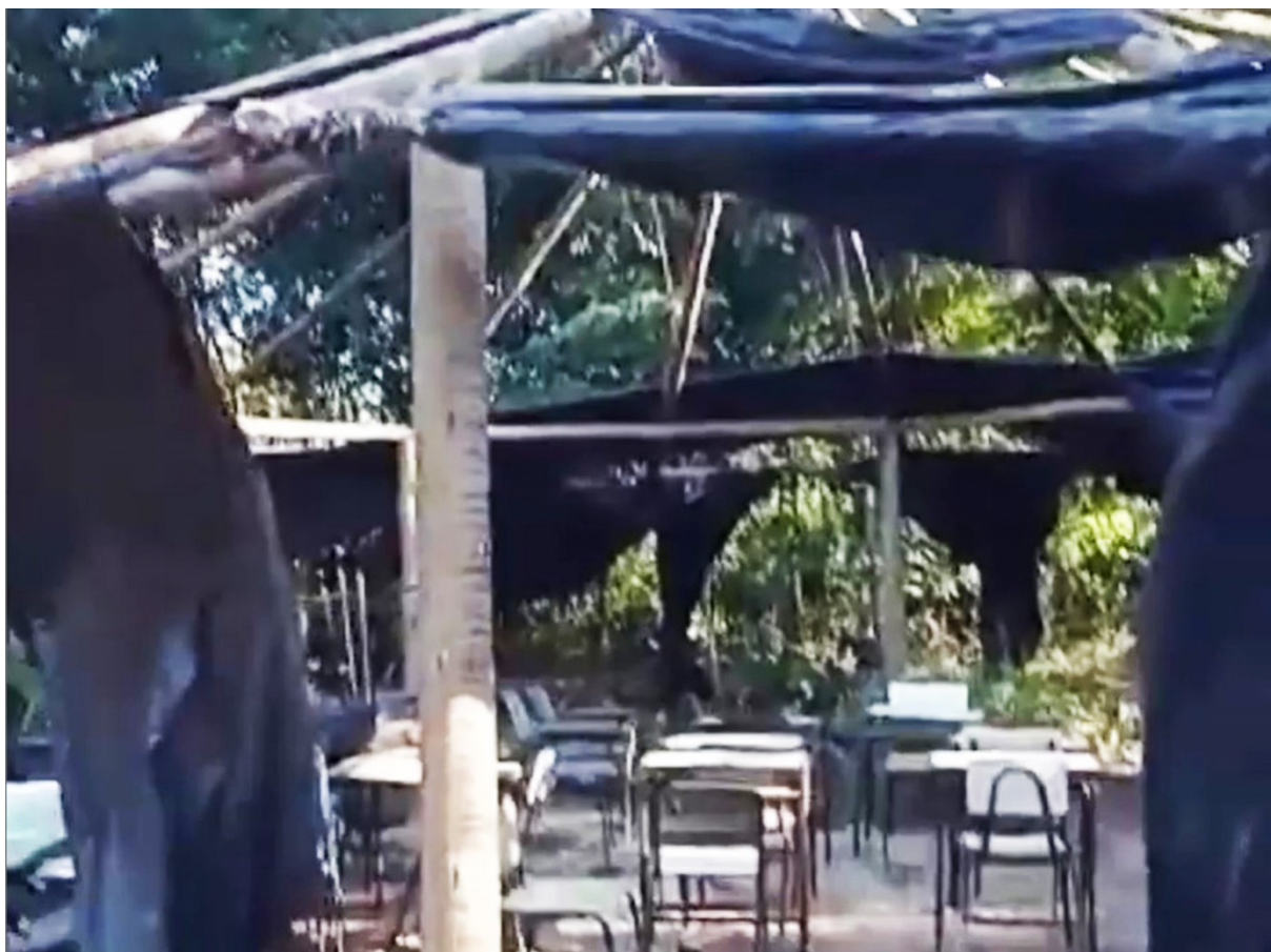
Figura 14: Escola da Katurãma destruídas após fortes chuvas na aldeia. Fonte: Publicado no Instagram @aldeiakaturama. Março de 2022.
