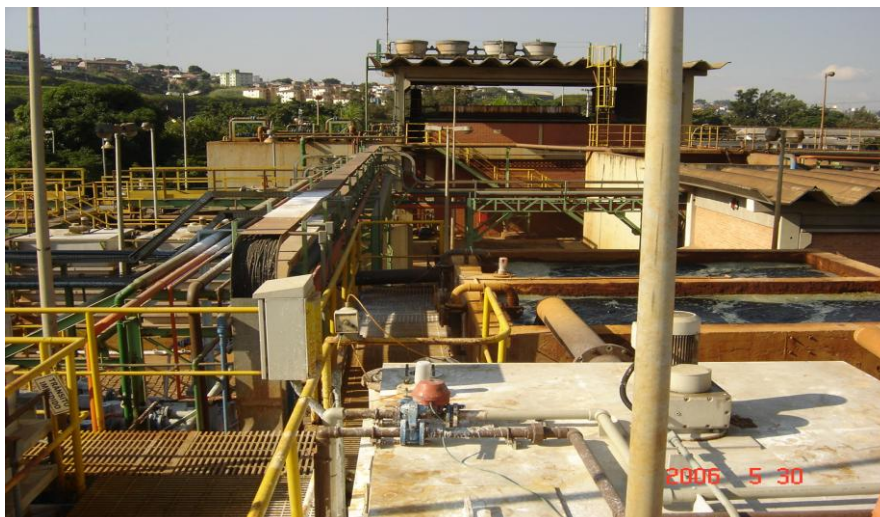
Figura 43 – Estação de Tratamento de Efluentes Fonte: Belgo Bekaert, 2007
