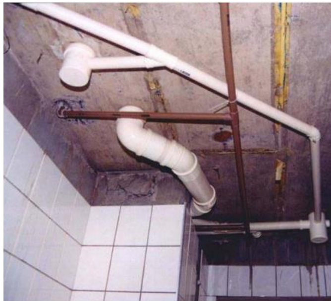
Figura 14 - Tubulações horizontais sob a laje a serem ocultas por forro.
