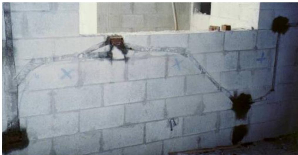
Figura 12 - Passagem de tubulação elétrica sem adequada integração de projetos
