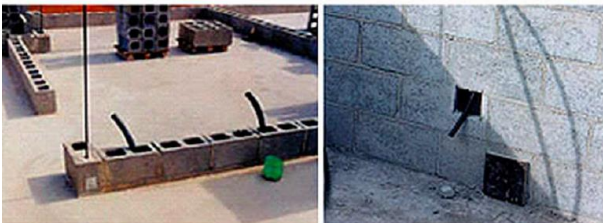
Figura 15 - Instalação elétrica embutida nas células dos blocos. Fonte: TAUIL E NESE, 2010.
