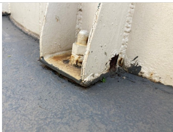
MG 2 – Corrosão severa em região junto à base
