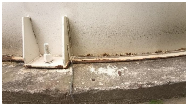
ES 1 – Chumbador sem comprimento necessário para duas porcas
