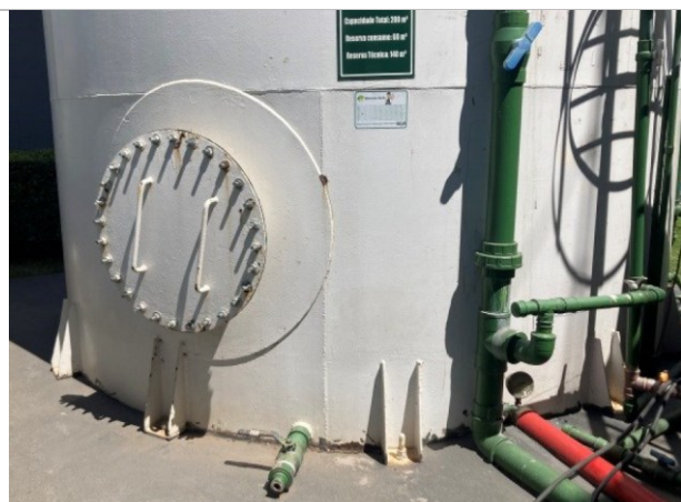
MG 2 – Corrosão generalizada em região da base e ancoragem
