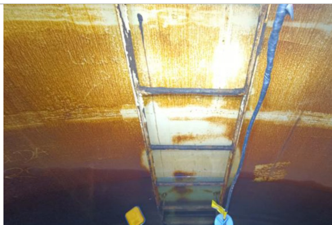
RJ CG – Corrosão severa uniforme e generalizada no costado e pilar central
