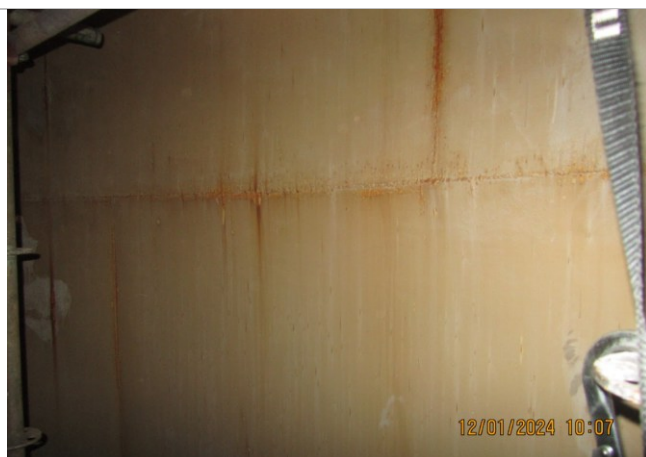
ES 1 – Corrosão uniforme generalizada no costado
