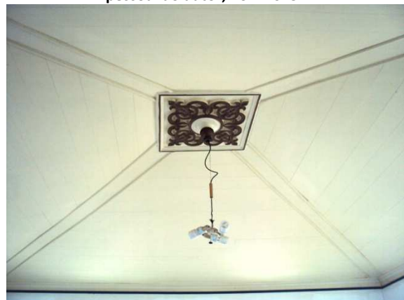
Figura 38: Vista parcial do forro de madeira em gamela localizado no Departamento de Aprovação de Projetos. Fonte: Acervo pessoal do autor, nov. 2015.
