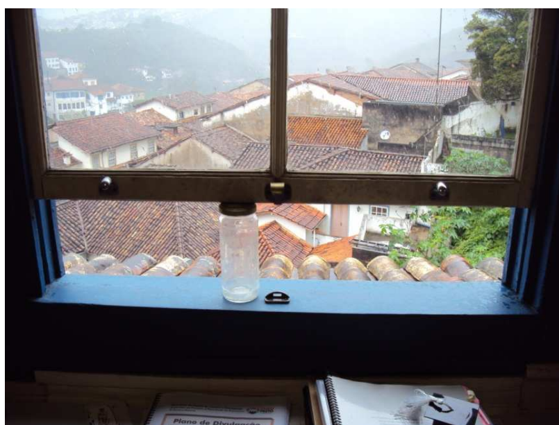
Figura 62: Vista Parcial de uma janela localizada no Segundo Pavimento onde os usuários utilizam um frasco de vidro para regular a área de entrada do vento no ambiente. Fonte: Acervo pessoal do autor, nov. 2015.
