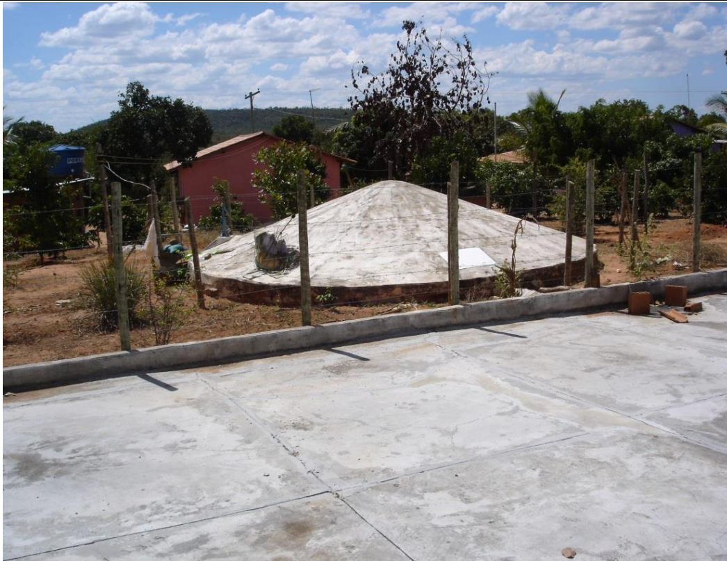
FOTO 12 – Cisterna de calçada para captar e armazenar água da chuva e abastecer as residências (abril, 2012)
