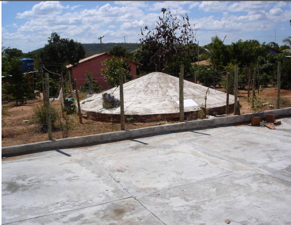
FOTO 12 – Cisterna de calçadão para captar e armazenar água da chuva e abastecer as residências (abril, 2012)
