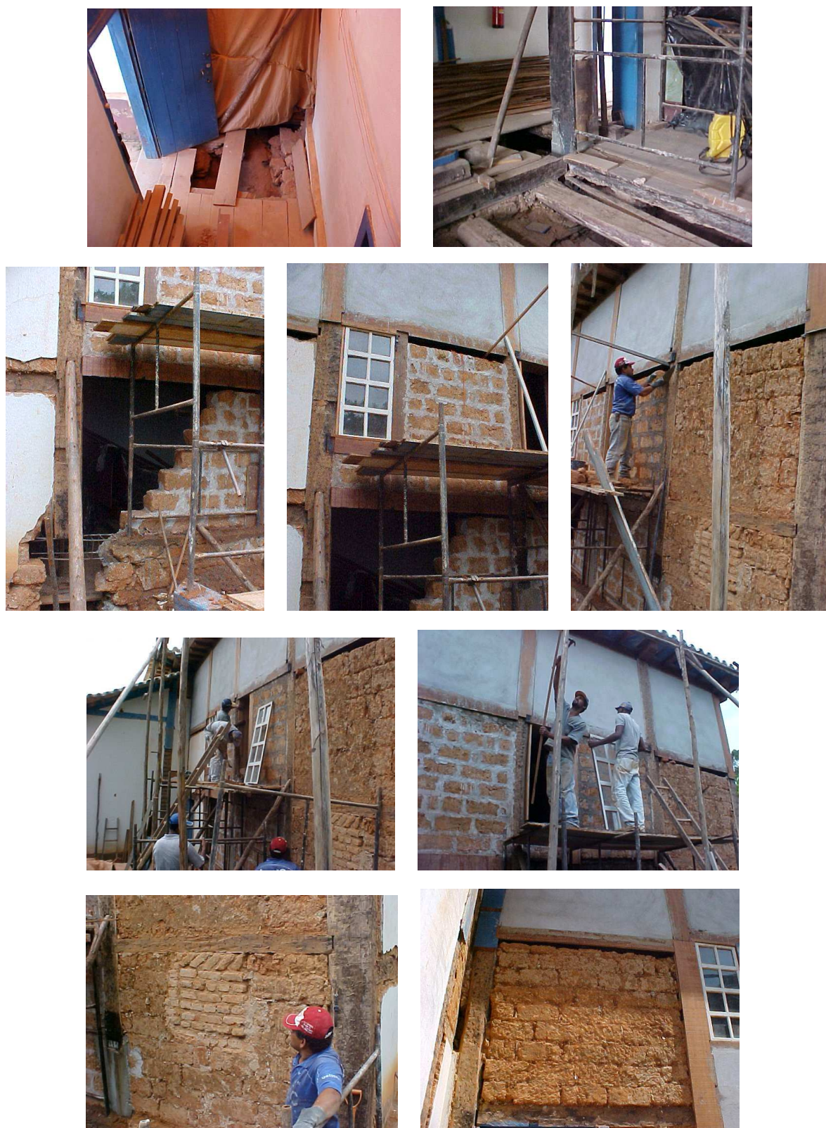
FIGURA 75: Obras da Igreja de Santo Antônio. Restauração do piso da sacristia. Desmonte do cancelo e do piso de tabuado da nave para substituição de baldrames apodrecidos. Substituição de madre apodrecida e dos marcos da janela. Reconstrução da alvenaria de adobe da capela-mor. Recomposição do reboco. Descoberta de janela entaipada na fachada lateral esquerda (lado da Epístola), na área da capela-mor. Fonte: fotos da autora, acervo do IEPHA/MG. Data: 30 setembro e 20 outubro 2004.
