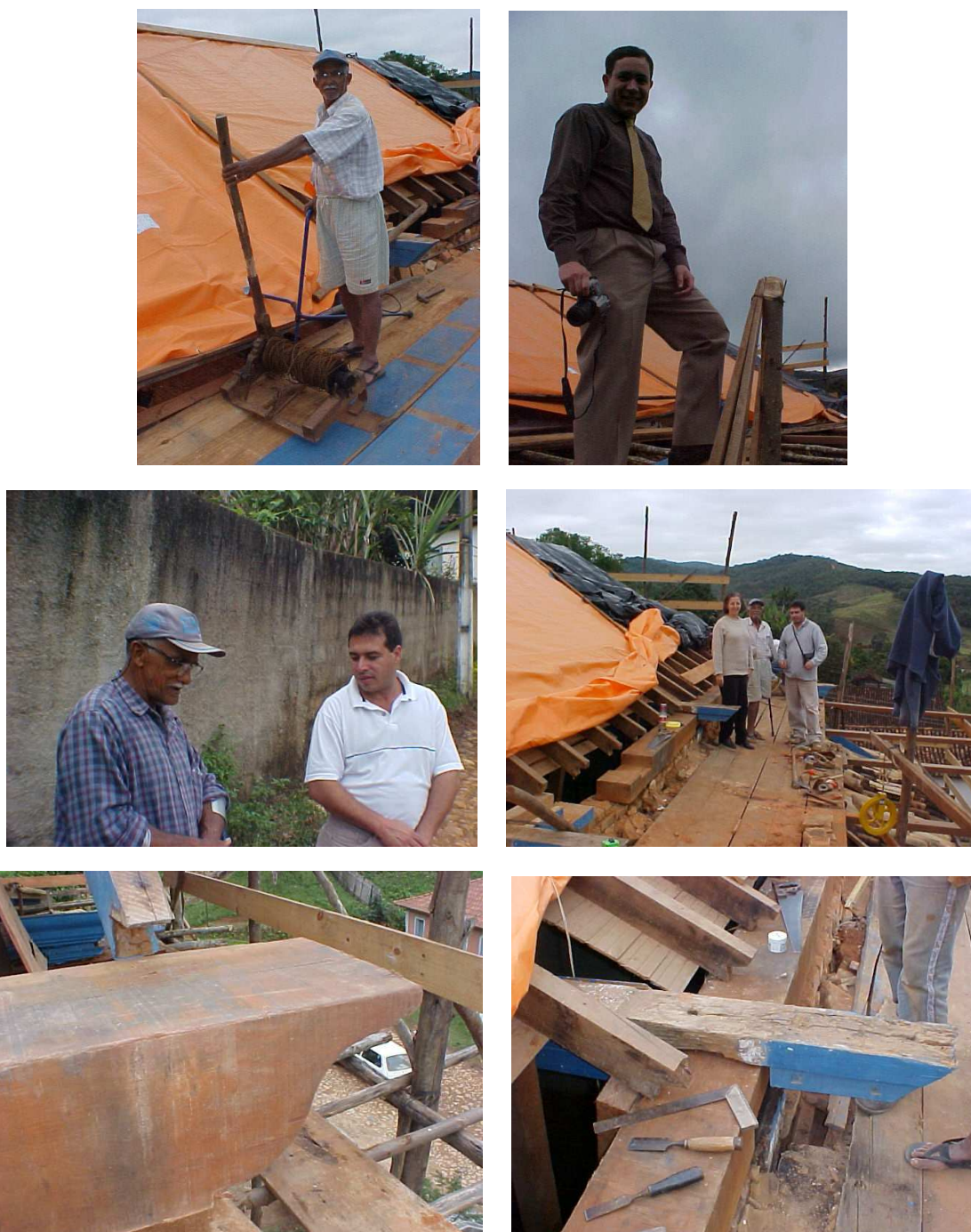
FIGURA 69: Obras da Igreja de Santo Antônio. O Mestre de Obras, Sr. Adelino, com catraca e correntes usadas para subida de peças maiores de madeira até o alto da cobertura. O Procurador, Dr. Marcos Paulo, em visita à obra. Reunião do Mestre de Obras, Sr. Adelino e o Engenheiro Adauto, responsável pelas obras. Visita técnica da arquiteta. Frechal novo substituindo o anterior que estava deteriorado. Telhado escorado por dentro e substituição de frechal da nave e substituição de peças deterioradas. Fonte: fotos da autora, acervo do IEPHA/MG. Data: 01 junho e 16 junho 2004.
