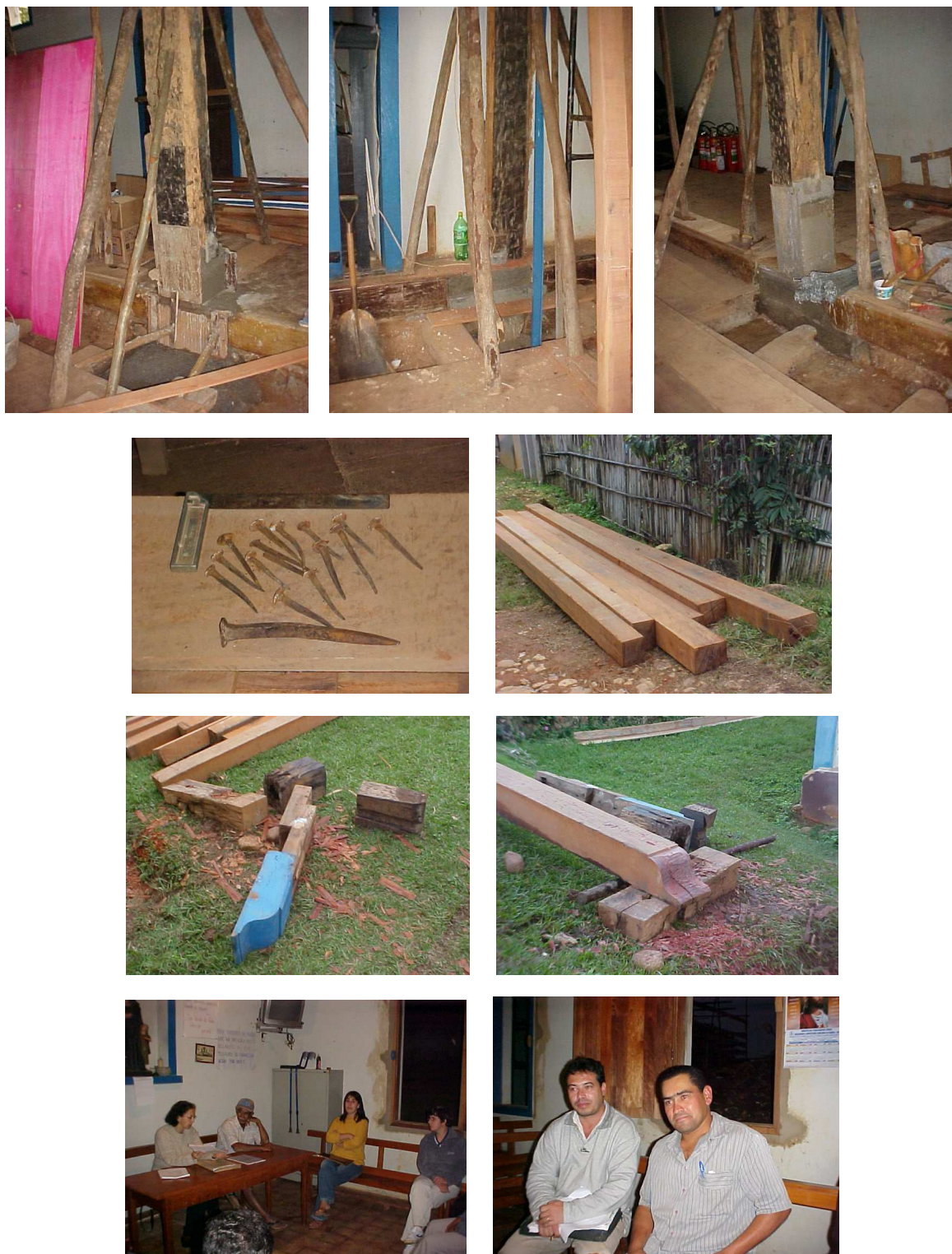
FIGURA 70: Obras da Igreja de Santo Antônio. Foram abertas covas ao redor dos pés de esteio, retirado os nabos, executada uma sapata com pilastra de concreto armado até a altura do esteio e emendado com placas de ferro. Os pés de esteios tinham sido cortados em intervenção anterior e os nabos que tinham sido deixados enterrados no solo foram agora retirados. Cravos retirados das madeiras apodrecidas que foram substituídos. Madeiramento comprado no estado do Pará especialmente para as obras desta edificação. Cabeça de esteio talhado com enxó, como era feito tradicionalmente. Reunião com a Comunidade para repasse das informações sobre os recursos existentes e o andamento das obras.
