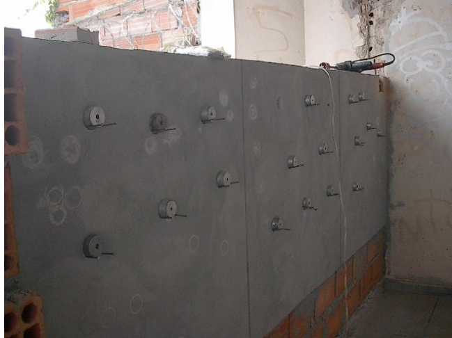
FIGURA 25 - Painéis prontos para execução dos testes de arrancamento e extração dos testemunhos para avaliação microestrutural.
