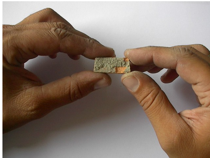
FIGURA 30 - Superfície do bloco cerâmico da amostra (para análise no MEV) após a retirada do revestimento argamassado.
