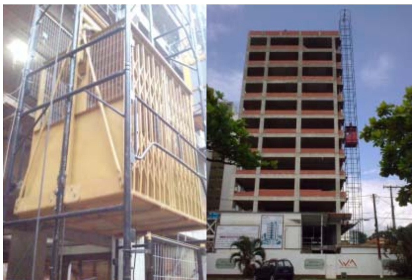
Figura 8: Elevador de Carga
