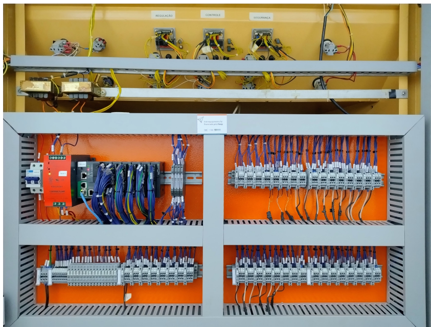
Figura 31 - CLP instalado na mesa de controle. (Conectado ao SMFN, SMRA e aos potenciômetros das barras de controle).
