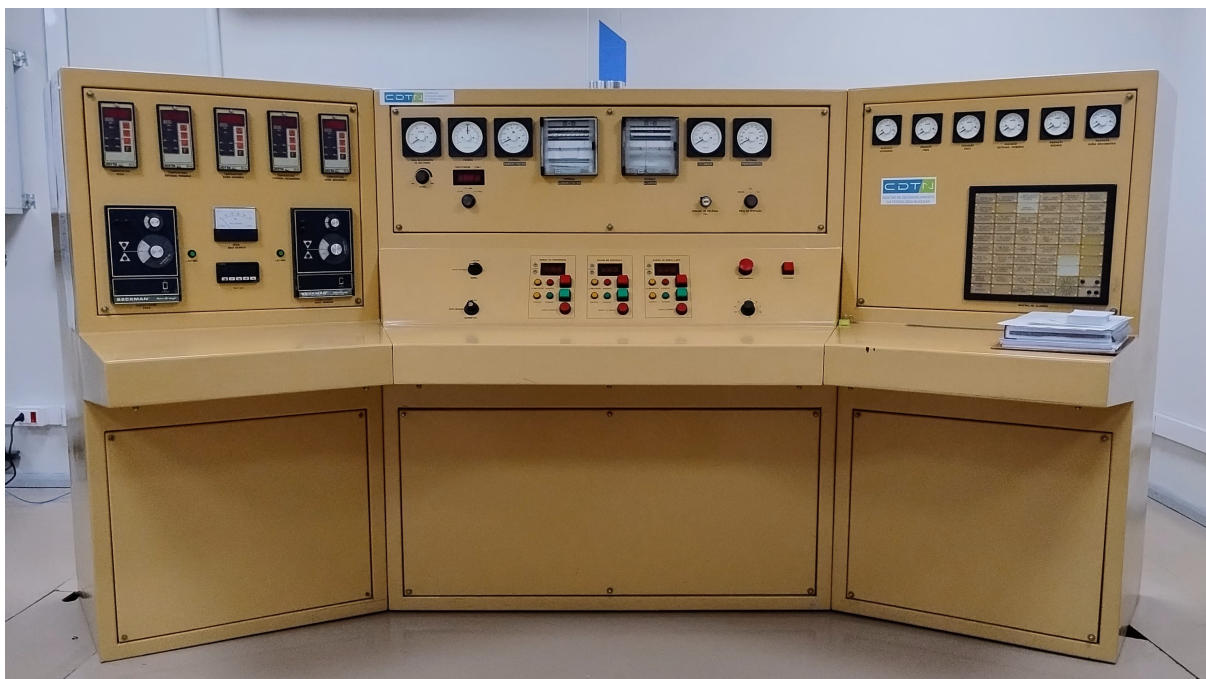
Figura 2 - Vista frontal da mesa de controle.
