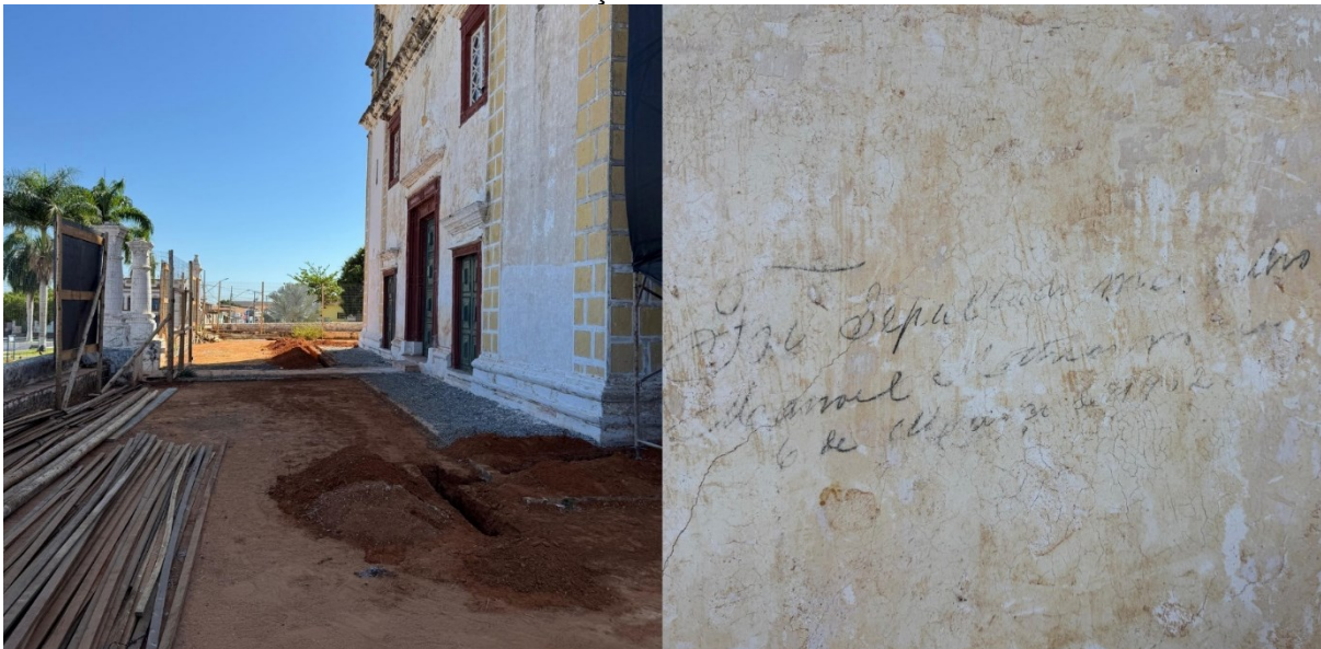
Figura 69 Vala aberta no átrio da igreja durante obra de restauro e parede externa da Matriz de N. S. da Conceição - Matias Cardoso
