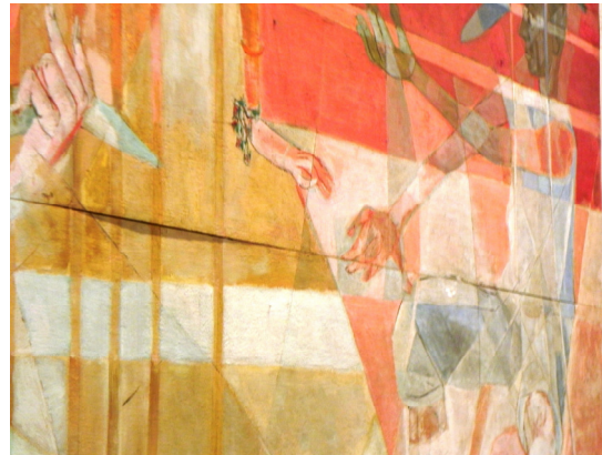
Figura 2: Detalhe abaulamento Fonte: Arquivo do projeto (2019)
