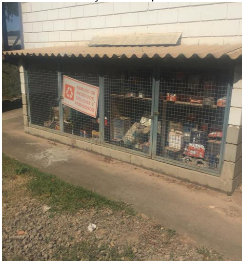
Figura 23 – Abrigo de resíduos perigosos com exposição ao sol, sem segregação e bacia de contenção de líquidos lixiviados.
