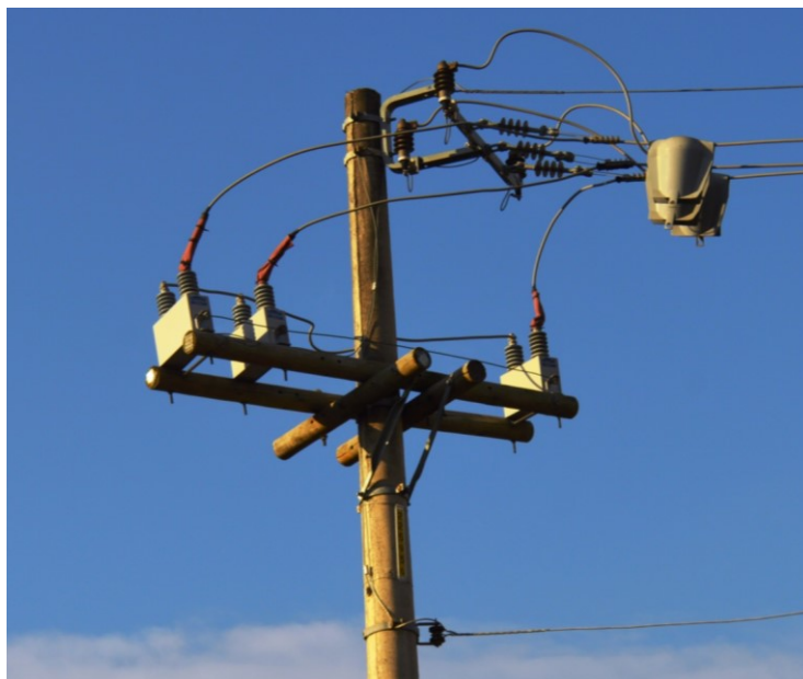
Figura 8 – Banco de capacitores de 300 kVAr instalado em poste. Fotografia do autor.
