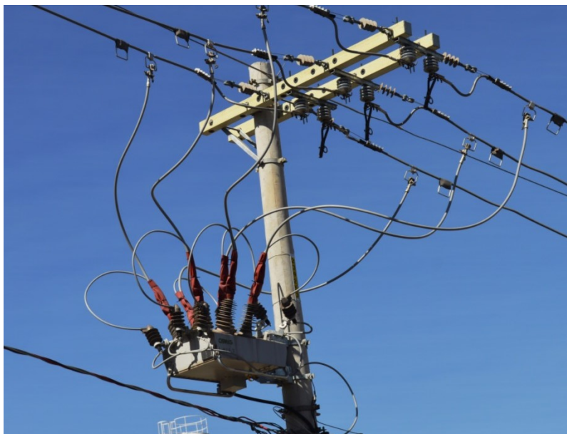
Figura 5 – Religador OSM® 27 Fab. Noja Power N°239253 instalado em poste. Fonte: fotografia do autor.
