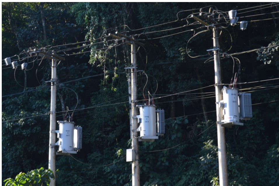
Figura 33 – Bancos de Reguladores de Tensão Nº209531 167 kVA Fab.TOSHIBA. Fotografia do autor.
