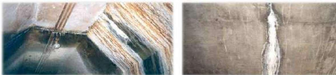
FIGURA 13: Lixiviação no concreto
