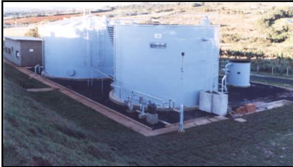
Figura 5. Instalação de Biodigestor UASB. Fonte: Granato (2003).
