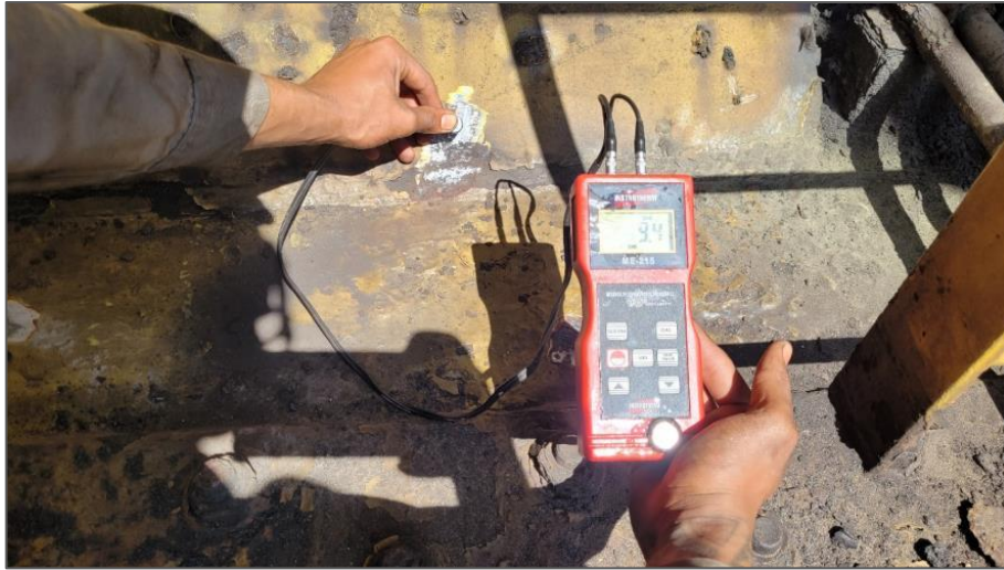
Figura 6 – Medição de espessura por ultrassom. (Fonte: Relatório interno de empresa de engenharia, 2024)
