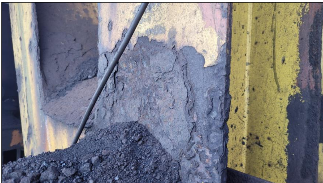
Figura 12 – Exemplo de corrosão estrutural em descarregadores de navios. (Fonte: Relatório interno de empresa de engenharia, 2024)
