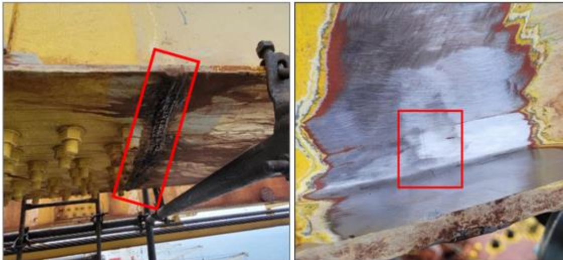
Figura 23 – Detalhe trinca na lança móvel. (Fonte: Elaborado pelo autor)
