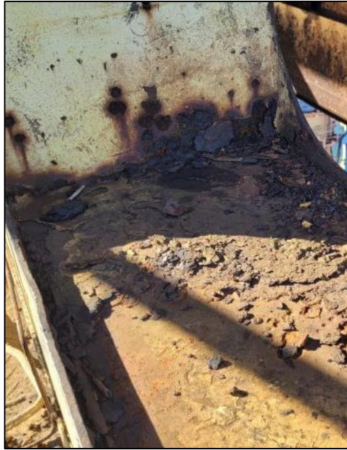
Figura 10 – Exemplo de corrosão estrutural em descarregadores de navios. (Fonte: Relatório interno de empresa de engenharia, 2024)
