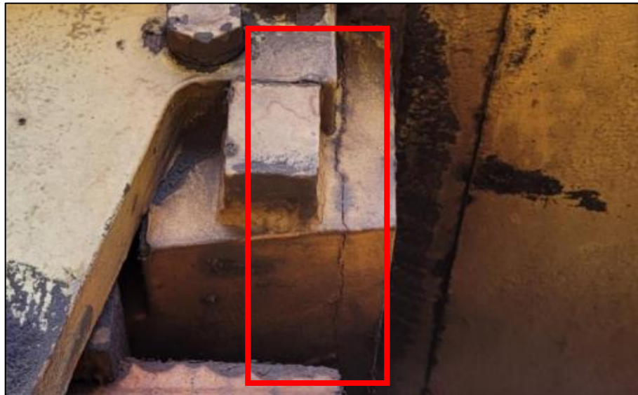
Figura 25 – Detalhe trinca nos blocos das rótulas dos trucks/pórticos. (Fonte: Elaborado pelo autor)
