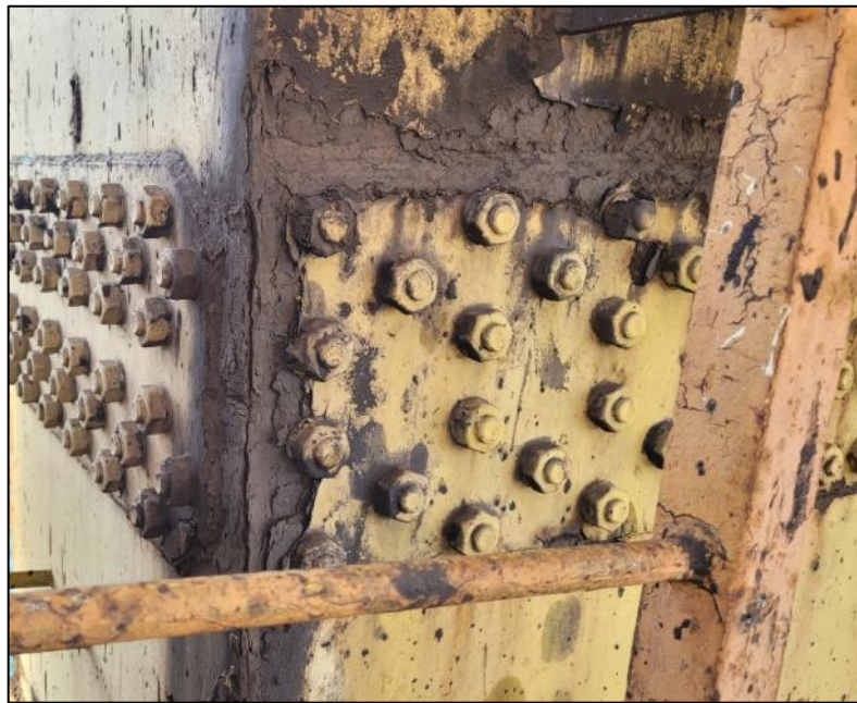
Figura 11 – Exemplo de corrosão estrutural em descarregadores de navios. (Fonte: Relatório interno de empresa de engenharia, 2024)
