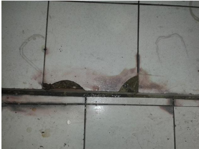
Figura 22: Manchas de umidade em revestimento cerâmico prensado Fonte: Acervo pessoal.
