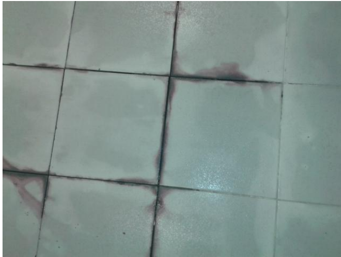
Figura 24: Manchas de umidade em revestimento cerâmico Fonte: Acervo pessoal.
