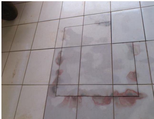
Figura 23: Manchas de umidade em revestimento cerâmico Fonte: Acervo pessoal.
