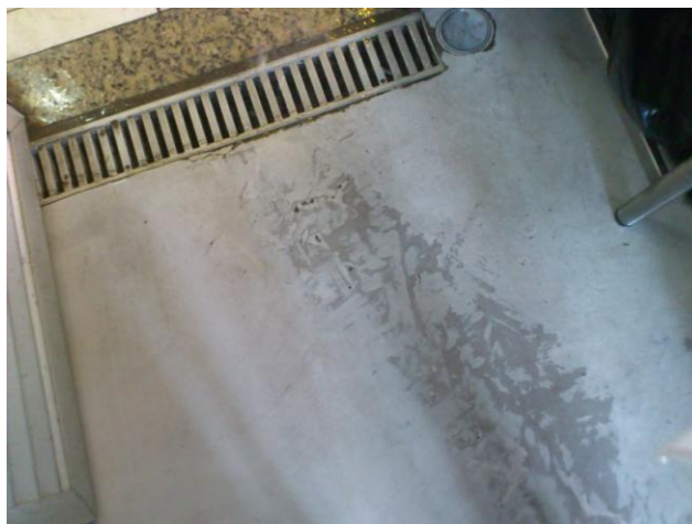
Figura 28: Desgaste superficial do revestimento em Junho/2013. Fonte: Acervo pessoal.
