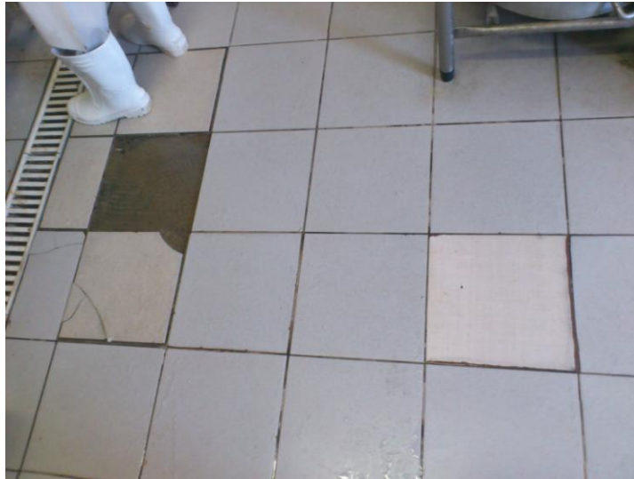
Figura 26: Descolamento de placa cerâmica prensada
