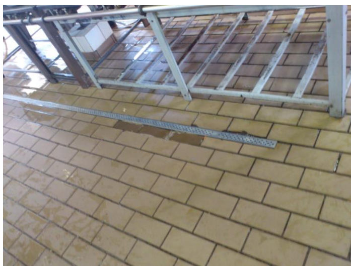
Figura 21: Quebra da quina da peça cerâmica extrudada
