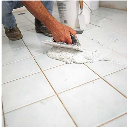
Figura 14: Rejuntamento do revestimento cerâmico Fonte: THIS OLD HOUSE.
