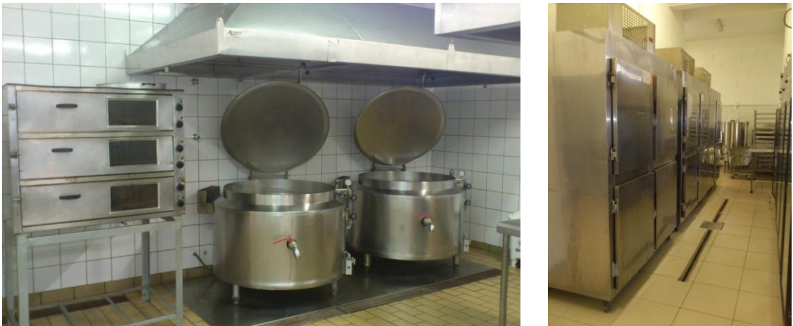
Figura 29: Exemplo de equipamentos existentes em cozinhas industriais: forno e caldeirões à esquerda; refrigeradores à direita.
