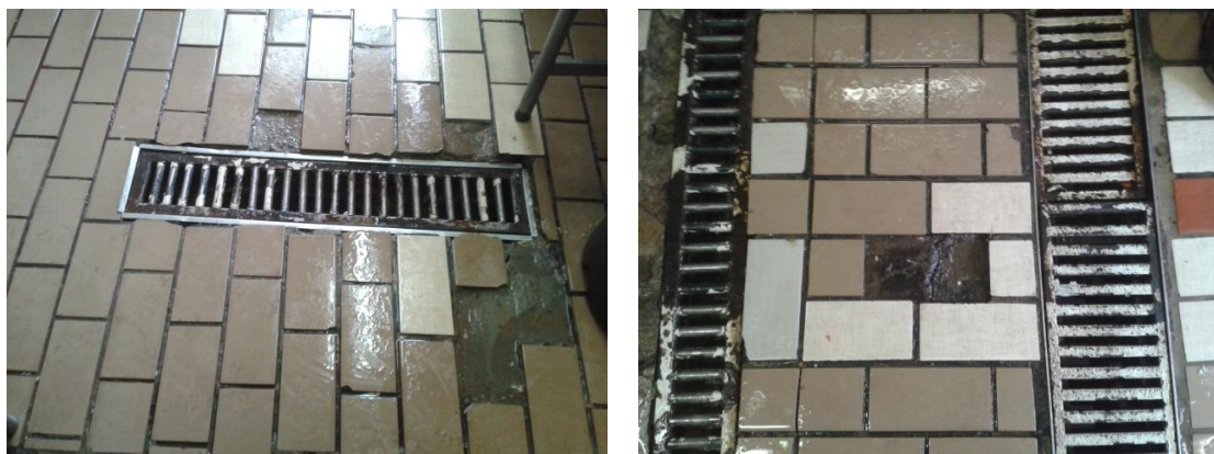
Figura 20: Descolamento do revestimento cerâmico extrudado
