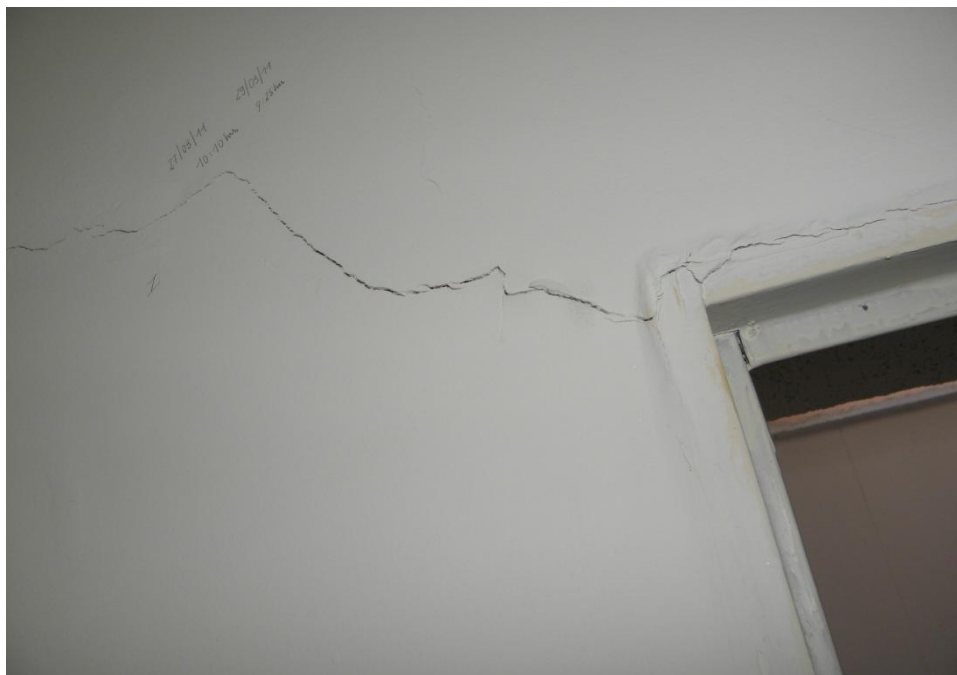
Fotografia 15 - Vista da trinca junto a parte superior da porta de entrada para o quarto de empregada
