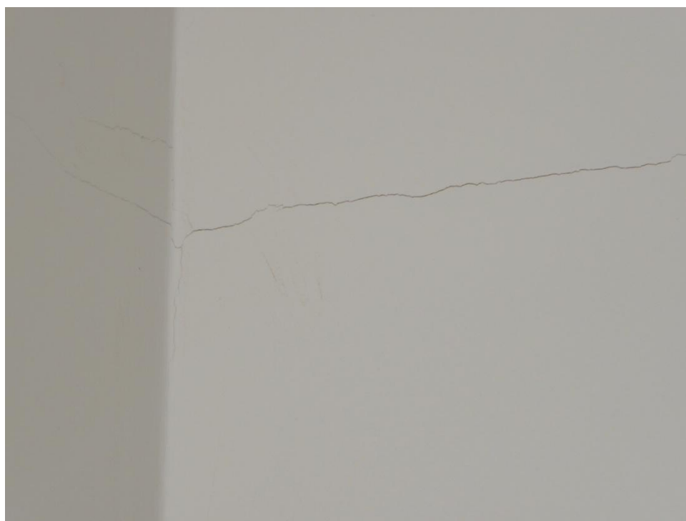
Fotografia 42 - Vista da trinca na parede da mesma suíte
