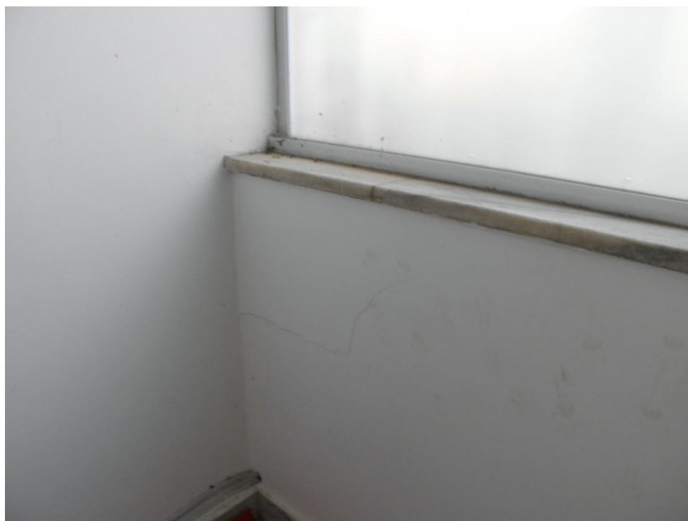
Fotografia 48 - Vista de trinca abaixo da janela acima da garagem, lado oposto da obra
