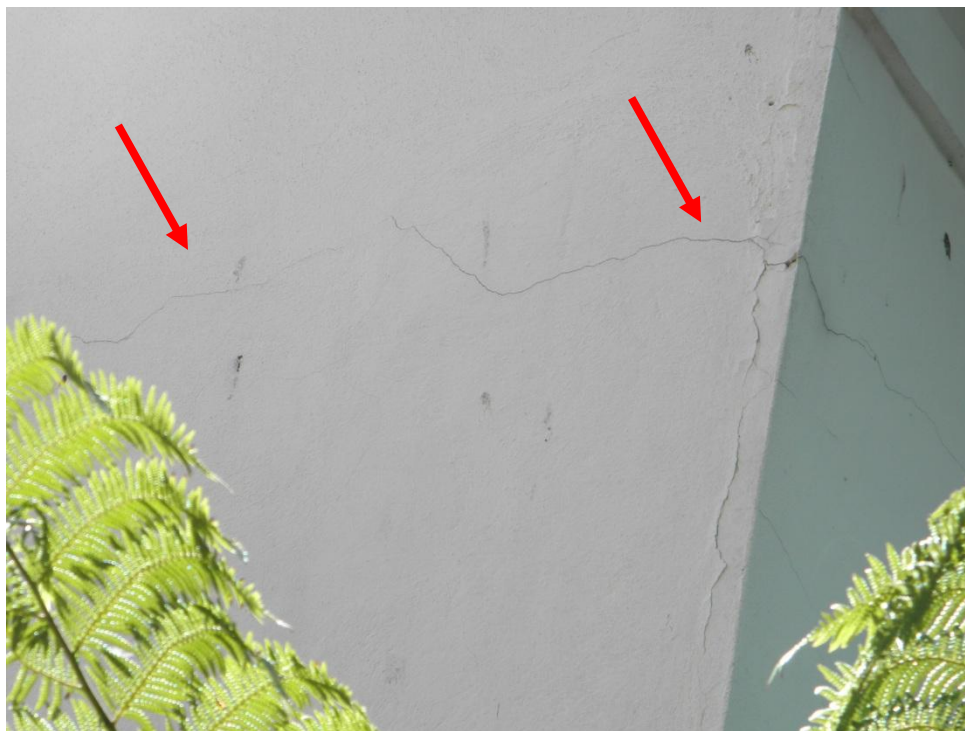
Fotografia 55 – Vista aproximada da mesma trinca
