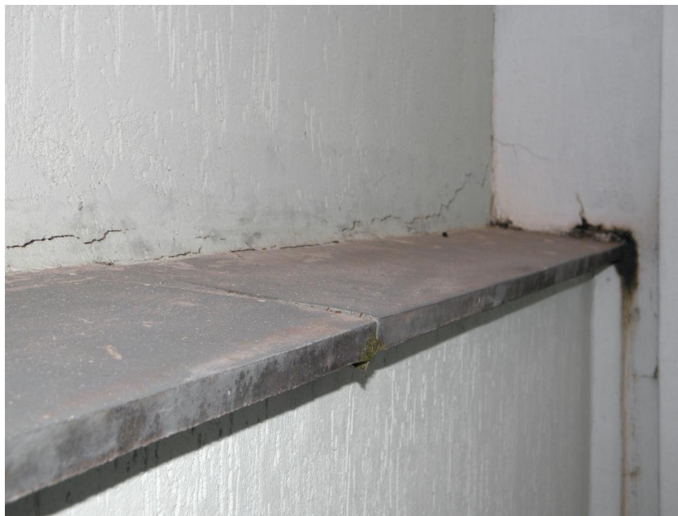
Fotografia 25 - Vista da trinca no muro lateral esquerdo do jardim de inverno
