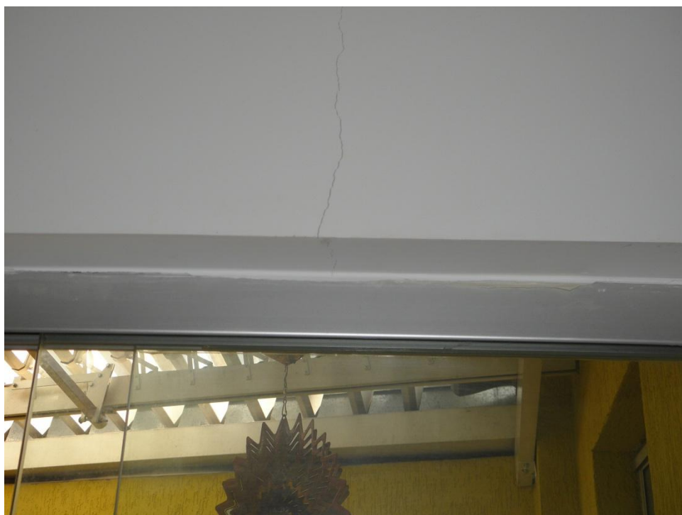
Fotografia 28 - Vista da trinca acima da porta de entrada para cozinha
