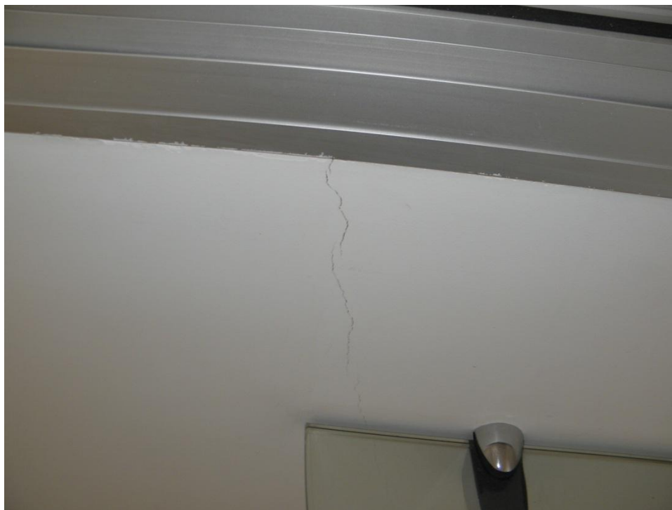
Fotografia 41 - Vista da trinca abaixo da mesma janela
