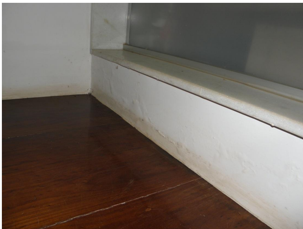
Fotografia 34 - Vista infiltração na parede da base da escada de acesso ao segundo piso
