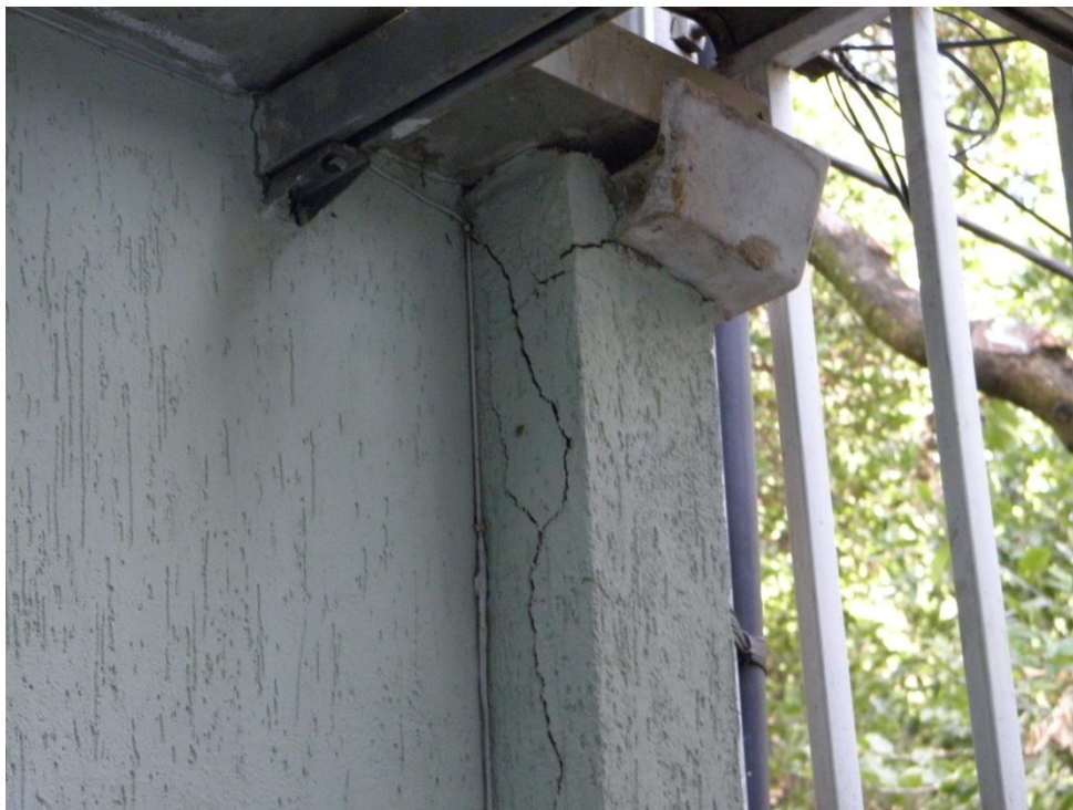
Fotografia 4 - Vista da trinca no encamisamento do tubo de decida de água de pluvial
