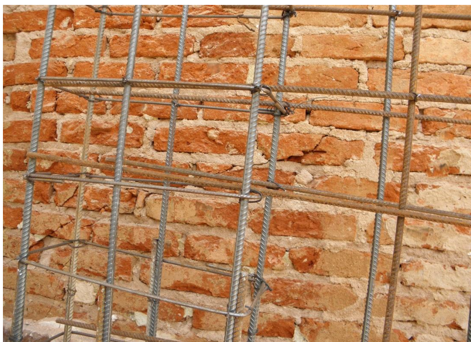
Fotografia 58 - Vista de rachadura no muro externo de alvenaria na divisa
