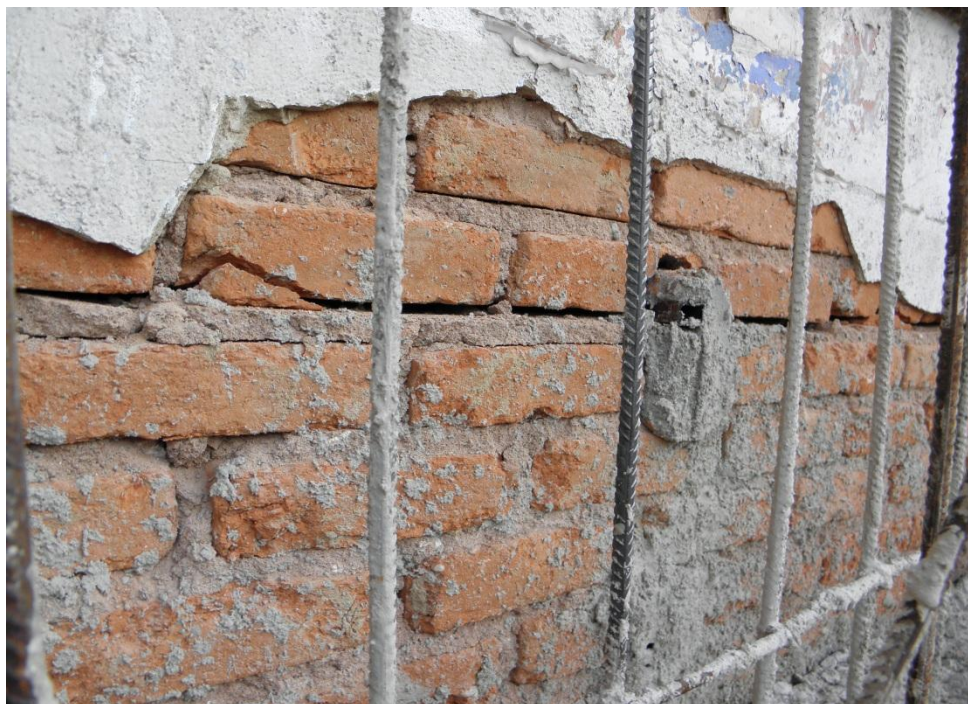
Fotografia 59 - Vista em outro ponto de rachadura no muro externo de alvenaria na divisa
