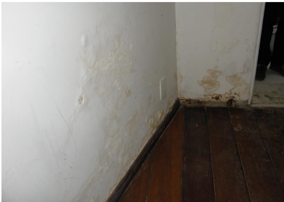
Fotografia 19 – Vista da umidade na base da parede do quarto de empregada
