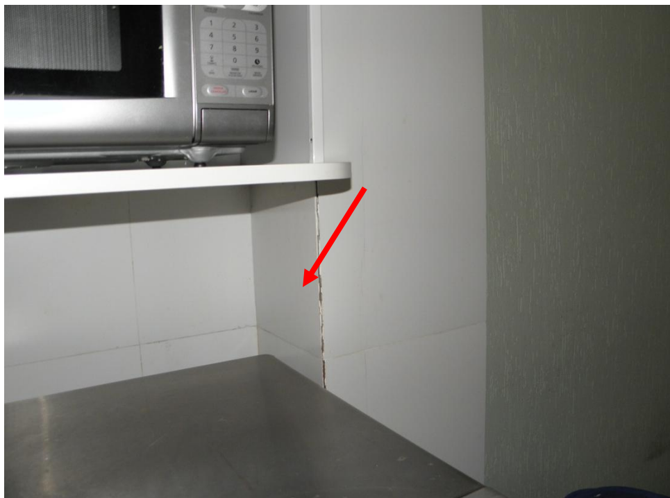
Fotografia 13 - Outra vista da área de serviço mostrando abertura na união do azulejo
