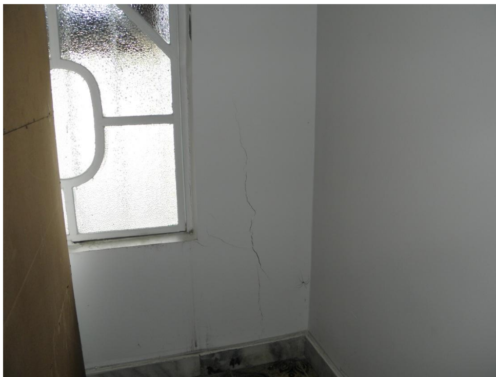
Fotografia 50 - Vista de trinca lado direito da mesma janela
