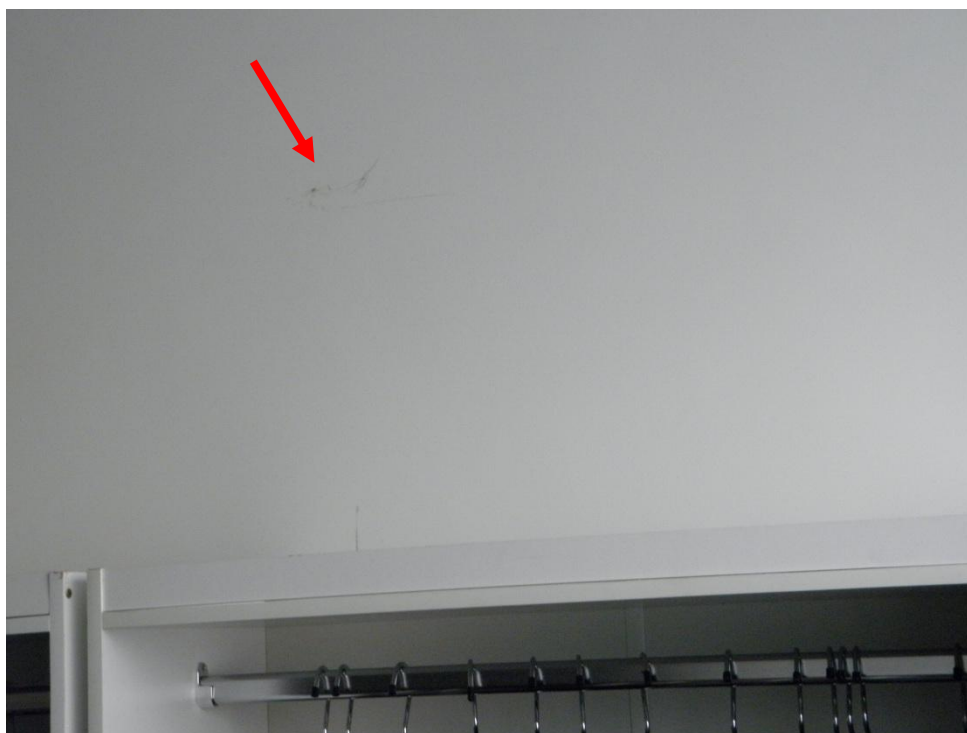
Fotografia 46 - Vista de trinca parede acima do armário do closet da suíte
