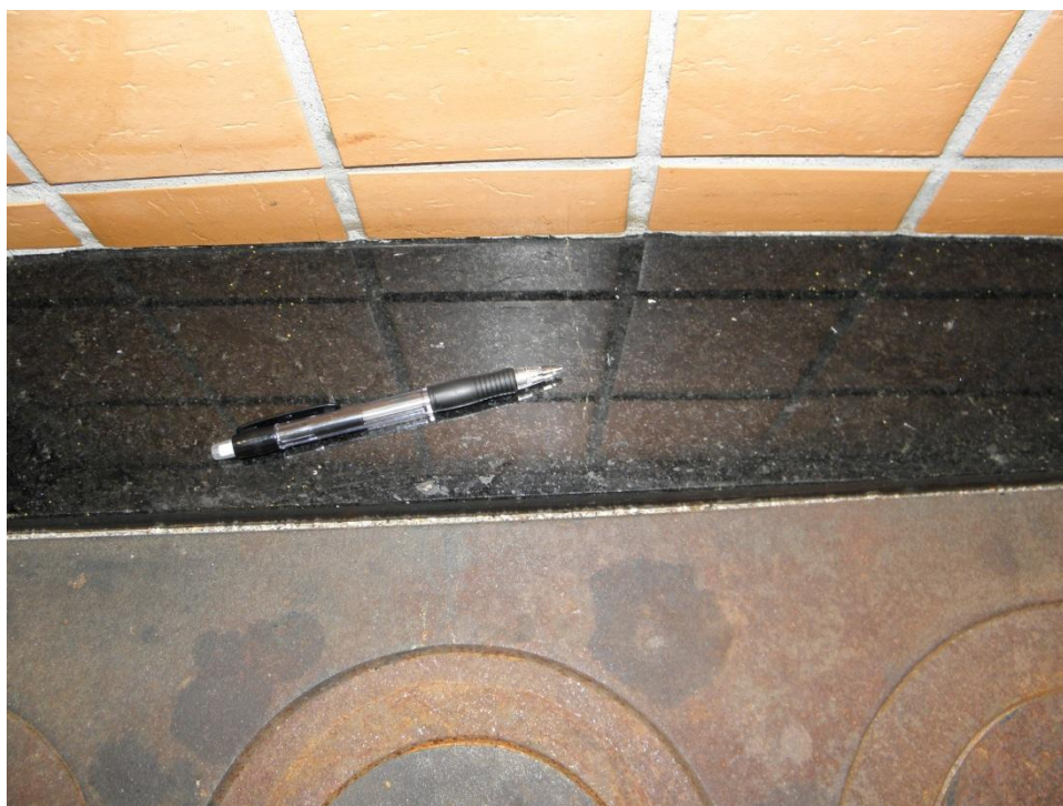
Fotografia 30 – Vista fissura no granito do fogão a lenha
