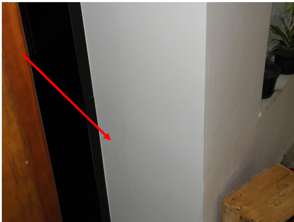
Fotografia 33 - Vista trinca na parede junto a porta
