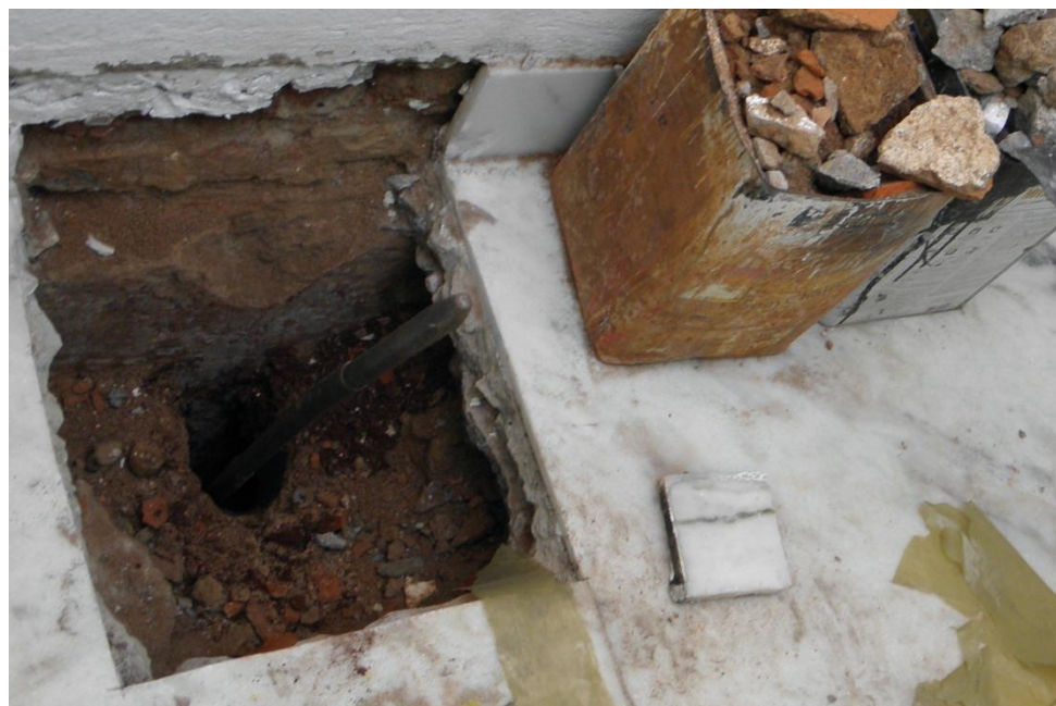
Fotografia 26 - Vista aproximada de abertura no piso mostrando a fundação e a umidade do solo
