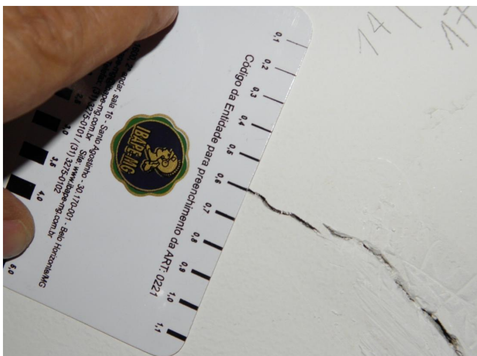
Fotografia 12 - Vista da espessura da trinca (0,6cm)
