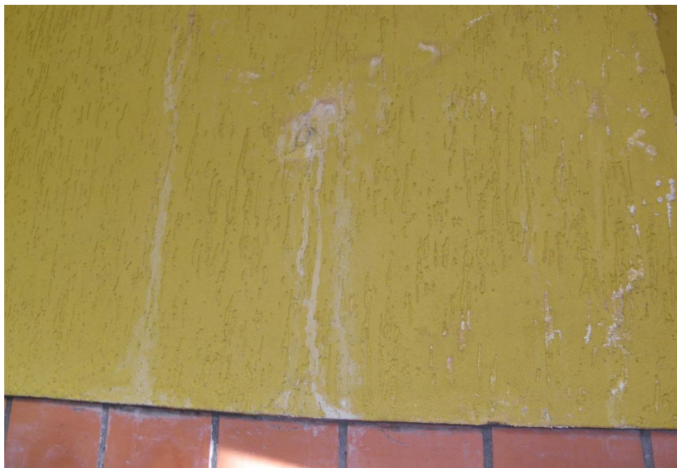
Fotografia 31 - Vista da eflorescência causada pela infiltração parede acima da bancada
