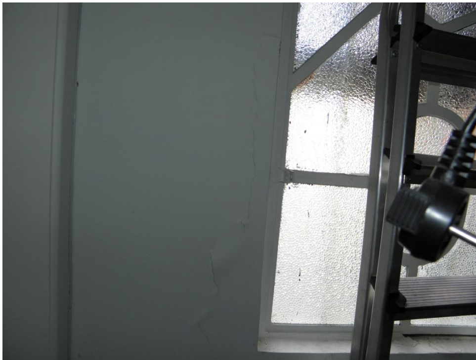
Fotografia 49 - Vista da trinca lateral esquerda da mesma janela
