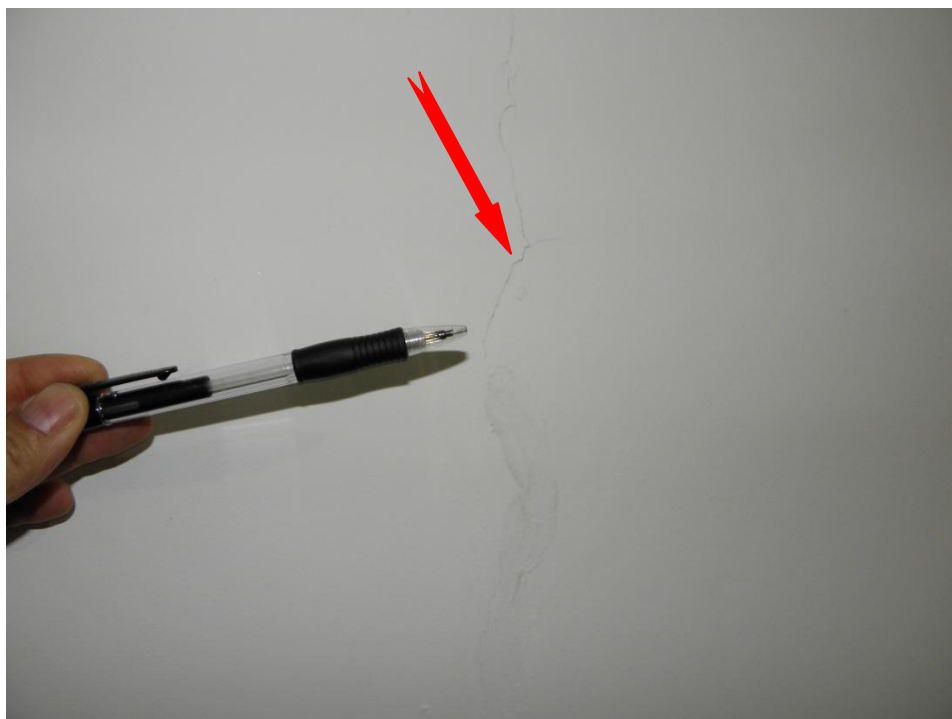
Fotografia 18 – Vista de trinca na parede lateral do quarto de empregada com divisa com a sala
