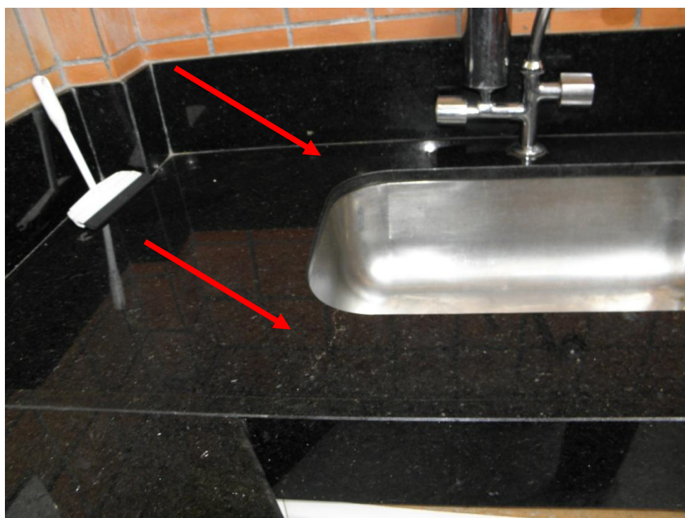
Fotografia 32 - Vista fissura na pia em granito da cozinha
