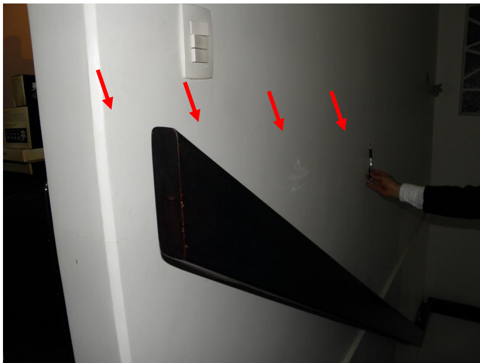
Fotografia 37 - Vista do prolongamento da mesma fissura longitudinal
