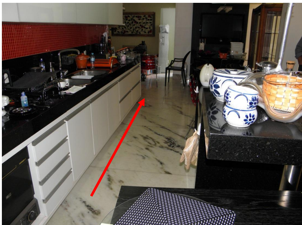
Fotografia 23 – Vista panorâmica na sala/cozinha da direção da trinca no piso em mármore e ao fundo porta para acesso ao jardim de inverno
