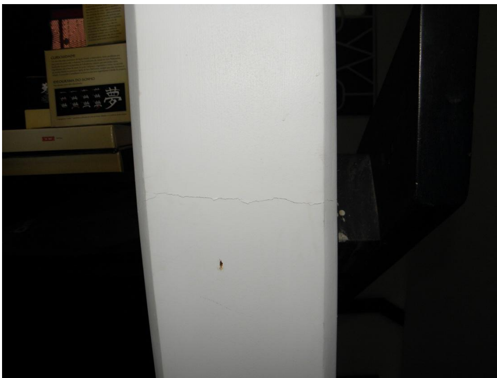
Fotografia 36 – Vista da fissura parede da escada
