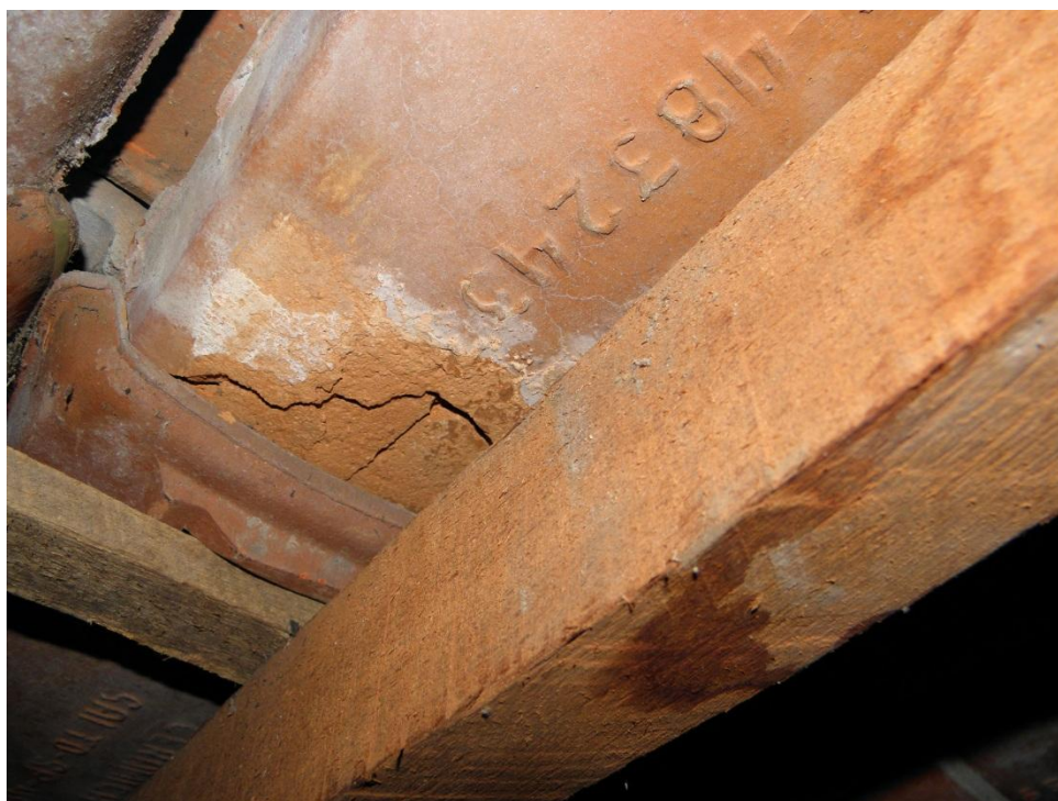
Fotografia 52 - Vista aproximada da telha com fratura que não se apresenta recente
