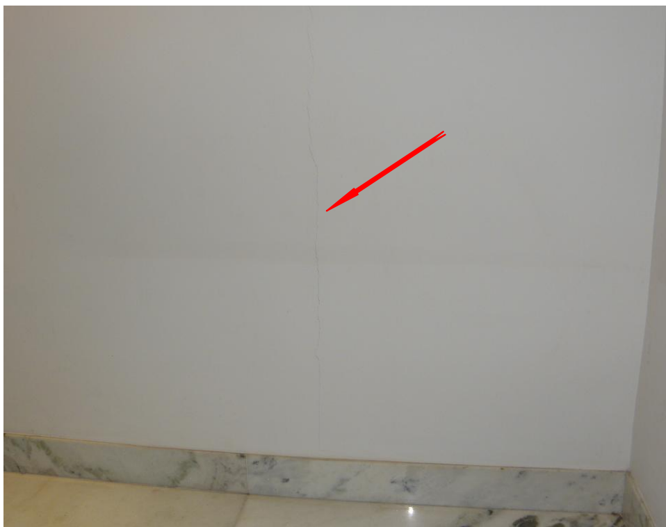
Fotografia 10 - Vista da trinca na parede da sala
