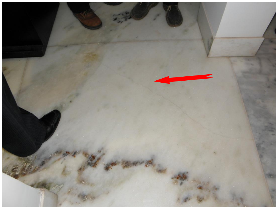
Fotografia 7 - Vista de outra trinca no piso em mármore da mesma sala
