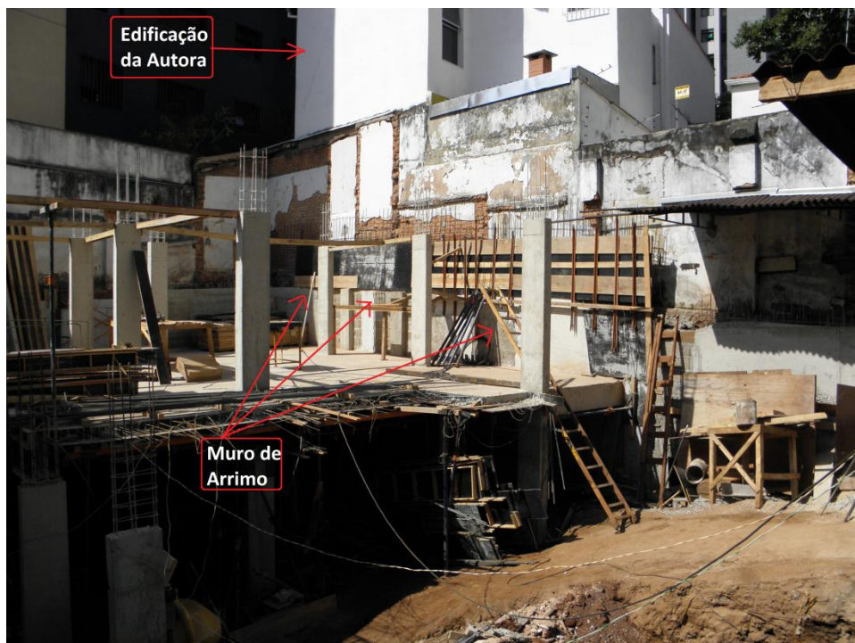
Fotografia 56 – Vista panorâmica da obra e muro de arrimo. Ao fundo a edificação da Autora
