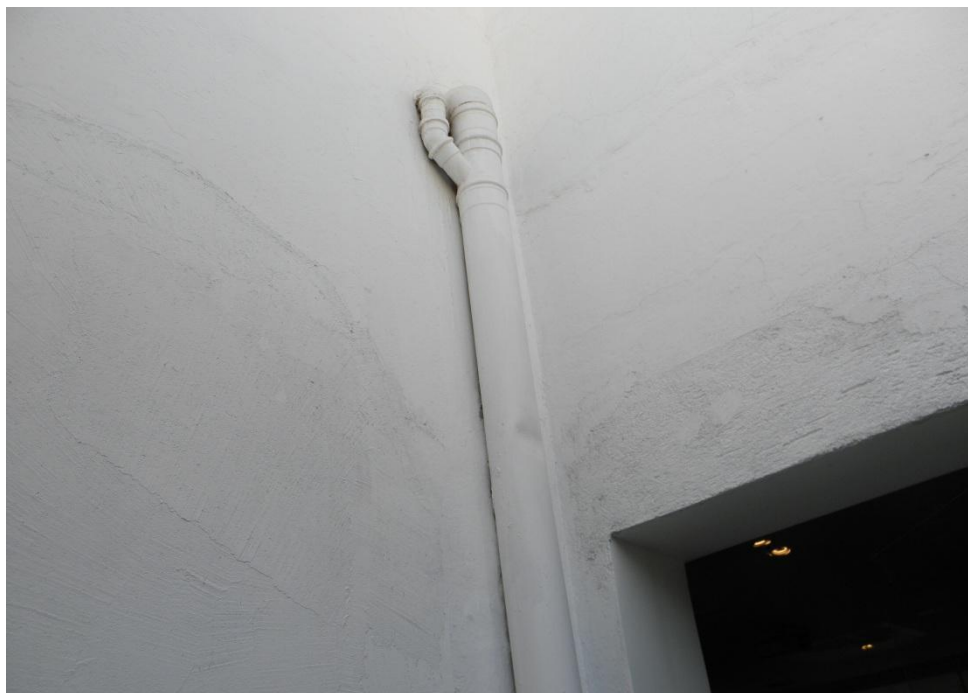
Fotografia 27 - Vista da tubulação de esgoto que desce ao lado da abertura para inspeção
