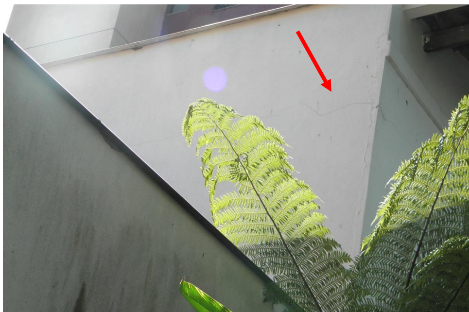
Fotografia 54 - Vista da trinca na fachada externa lateral esquerda do imóvel da Autora
