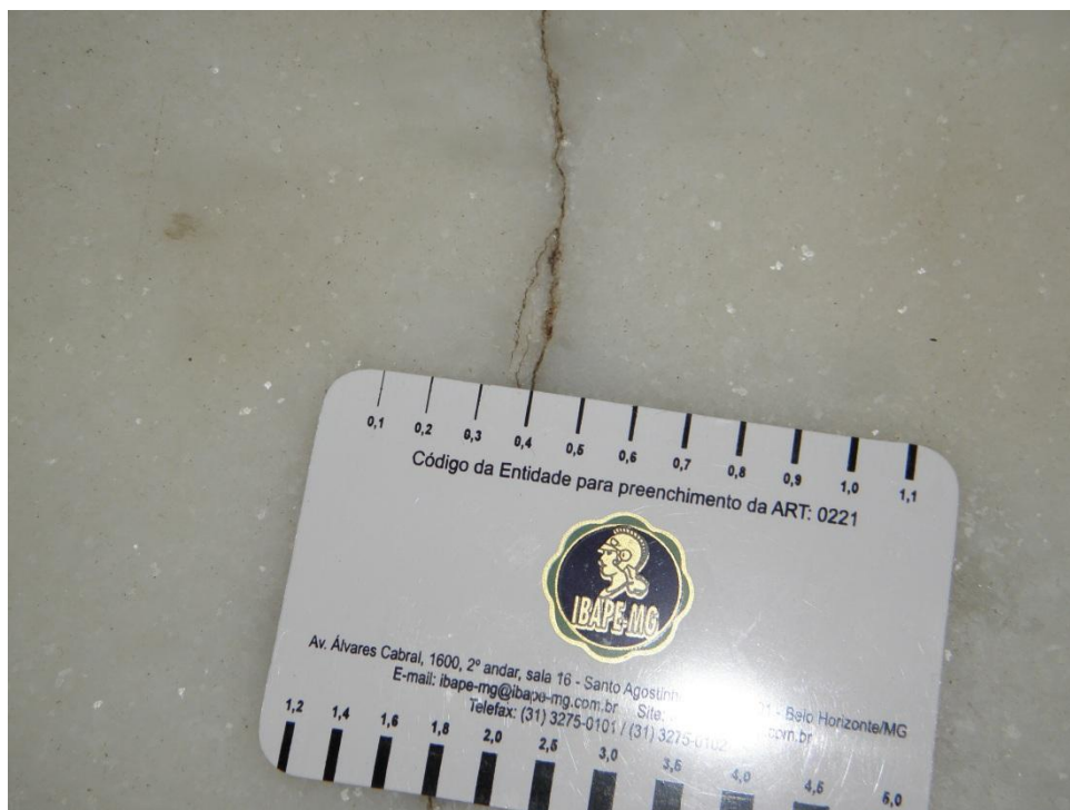
Fotografia 6 - Vista da espessura da fissura (0,4cm)
