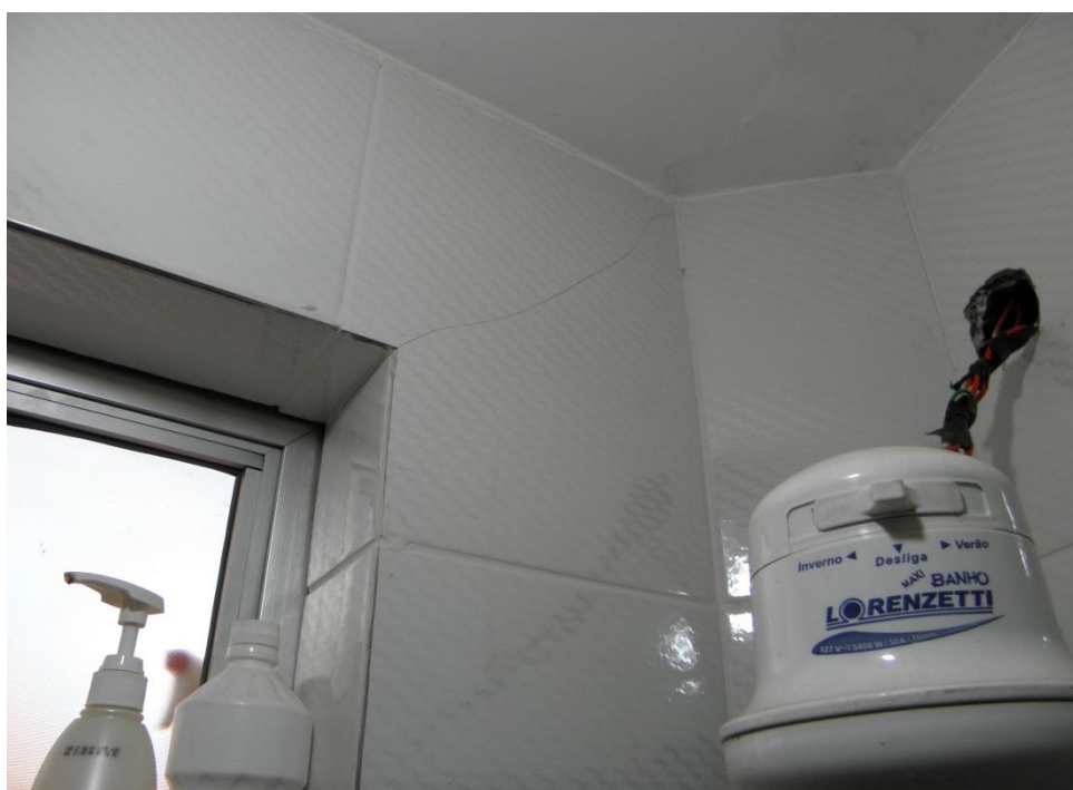
Fotografia 20 – Vista trinca no azulejo canto esquerdo superior da janela do banho de empregada
