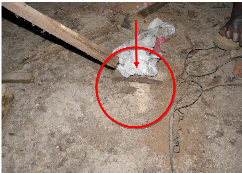
Fotografia 53 - Vista do ponto de impacto da água na laje, logo abaixo da telha quebrada, onde existe um afastamento da poeira causado pelo gotejamento. Esse ponto se localiza exatamente sobre teto da suíte de solteiro onde existe mancha de infiltração
