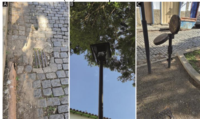
Figura 28: À esquerda (A) Bueiro entupido. No centro (B) Iluminação danificada. À direita (C) Lixeira quebrada.
