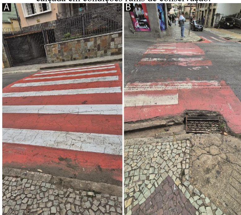
Figura 47: À esquerda (A) Ausência de rampas de acessibilidade. À direita (B) Acesso à calçada em condições ruins de conservação.
