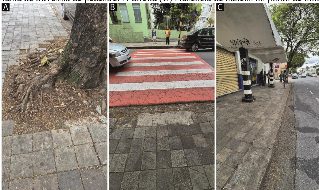
Figura 49: À esquerda (A) Raízes danificando a calçada. No centro (B) Ausência de rampas na faixa de travessia de pedestre. À direita (C) Ausência de bancos no ponto de ônibus.
