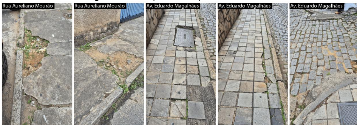
Figura 58: Condições das calçadas no Percurso 3.
