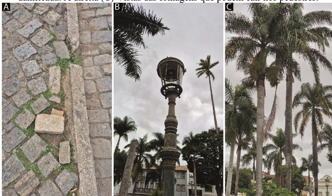
Figura 45: À esquerda (A) Pedras soltas na Praça Frei Orlando. No centro (B) Iluminação danificada. À direita (C) Vistas das folhagens que podem cair nos pedestres.
