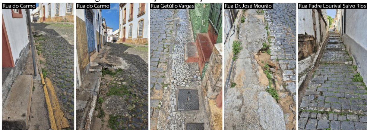
Figura 56: Condições das calçadas no Percurso 1.
