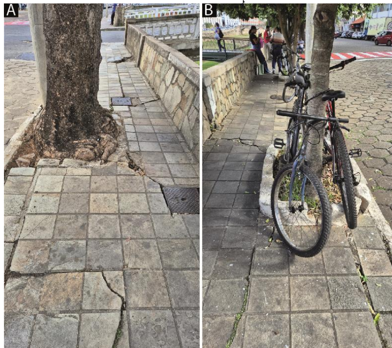
Figura 32: À esquerda (A) Calçadas danificadas pelas raízes das árvores. À direita (B) Obstáculos na calçada.
