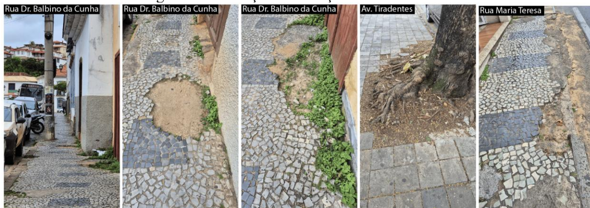
Figura 59: Condições das calçadas no Percurso 4.
