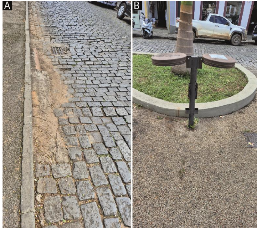
Figura 35: À esquerda (A) Bueiro entupido. À direita (B) Lixeira danificada na Praça Severiano de Resende.
