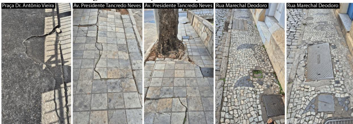
Figura 57: Condições das calçadas no Percurso 2.
