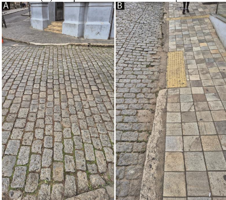
Figura 42: À esquerda (A) Ausência de faixa de pedestre próxima à Prefeitura e à Câmara Municipal. À direita (B) Rampa de acessibilidade na calçada do Banco do Brasil.
