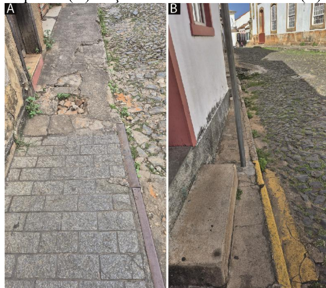
Figura 21: À esquerda (A) calçada com buracos. À direita (B) calçada curta.
