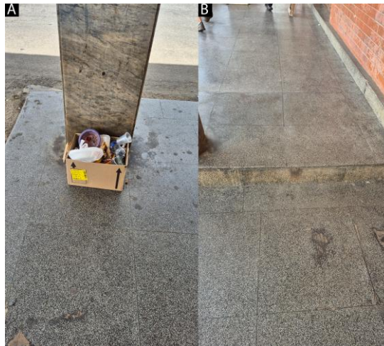
Figura 29: À esquerda (A) Acúmulo de lixo. À direita (B) Ausência de rampa de acessibilidade.
