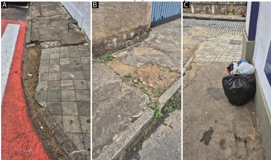
Figura 40: À esquerda (A) Rampa de acessibilidade danificada. No centro (B) Calçada com buracos. À direita (C) Lixo na calçada.
