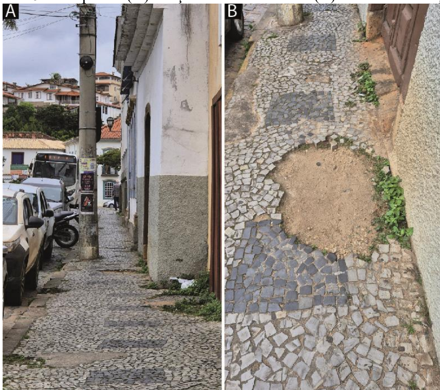
Figura 46: À esquerda (A) Calçada curta. À direita (B) Buracos na calçada.
