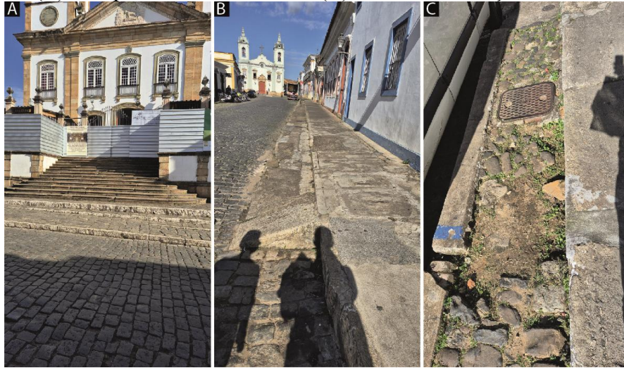
Figura 26: À esquerda (A) Escadaria da Catedral Basílica de Nossa Senhora do Pilar. No centro (B) Rampa inclinada. À direita (C) Desnível da calçada com buracos.
