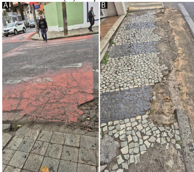
Figura 50: À esquerda (A) Ausência de rampas de acessibilidade na faixa de pedestre. À direita (B) Calçadas danificadas.
