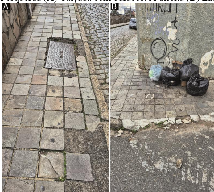
Figura 41: À esquerda (A) Calçada com buracos. À direita (B) Lixo na calçada.
