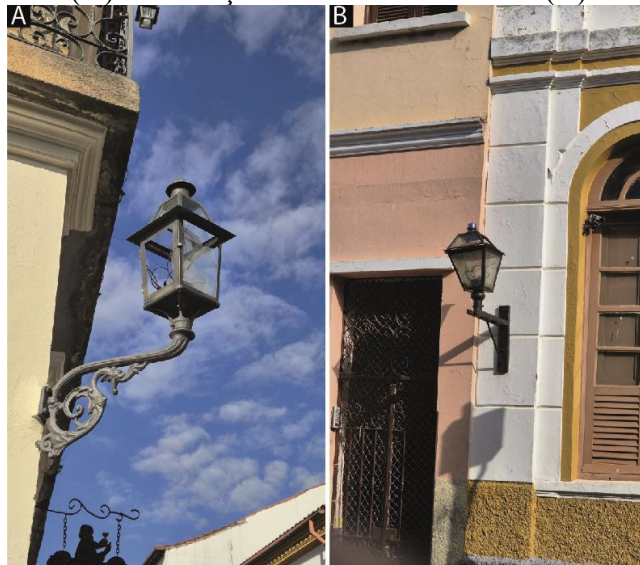
Figura 23: À esquerda (A) Iluminação danificada. À direita (B) iluminação queimada.
