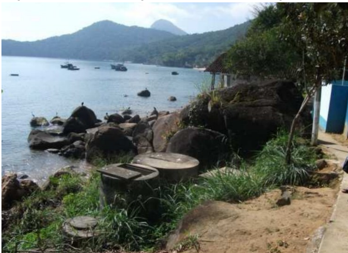
Figura 53 - Estação elevatória de esgoto na comunidade de Araçatiba, Angra dos Reis – RJ
