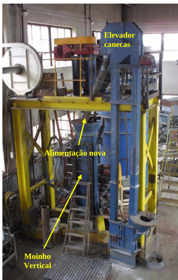
Figura 4.2 – Vista geral do circuito com moinho vertical piloto (VALE 1 )
