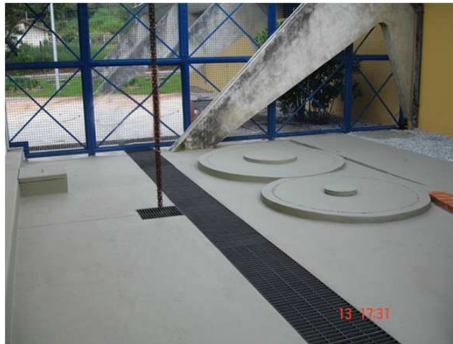
Figura 4.15: Disposição final do sistema de tratamento de efluentes do LELF.
