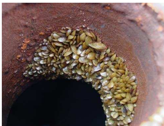
Figura 4.1: Colônia de Limnoperna fortunei em conduto forçado.
