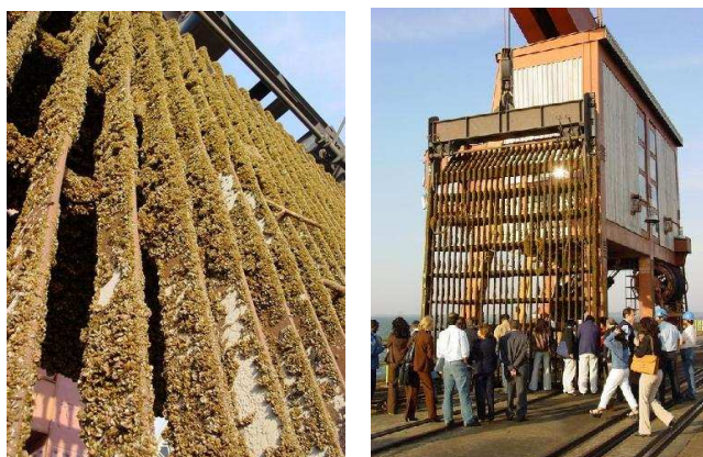
Figura 3.9: Grade de tomada d'água de uma Usina Hidrelétrica incrustada com L. fortunei .
