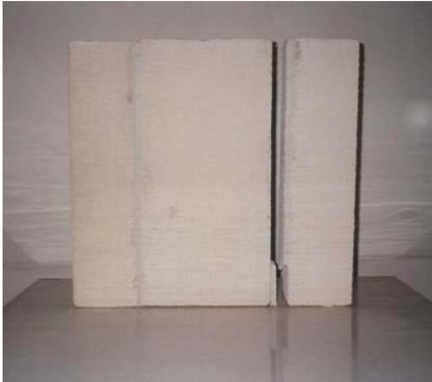
Figura 72 – Descolamento em ambas interfaces unidade/argamassa
