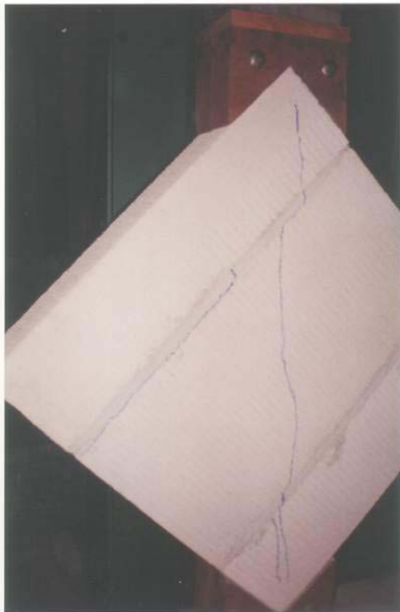
Figura 74 – Ruptura no bloco e na junta de argamassa
