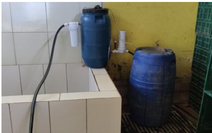
Figura 11: Filtro sanitizante instalado no galpão principal da empresa. Fonte: Elaborada pelo autor.
