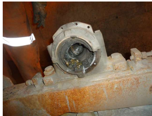
Figura 22 - Quebra do mancal do lado oposto ao eixo fraturado.
