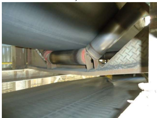
Figura 19 - Estrutura física do transportador e sustentação da correia.
