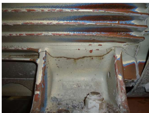
Figura 27 - Detalhe da trinca na base do motor.
