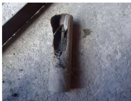
Figura 20 - Rolete de transportador de correia danificado.
