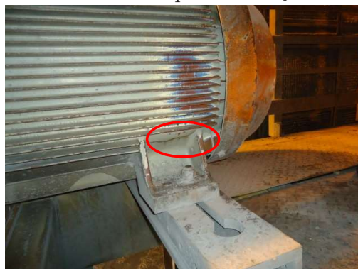
Figura 26 - Trinca na base do motor e detalhe do suporte de fixação.
