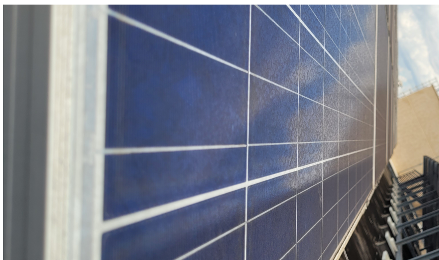
Figura 20 – Sujeira em Condição Inicial na Usina FV - TESLA.
