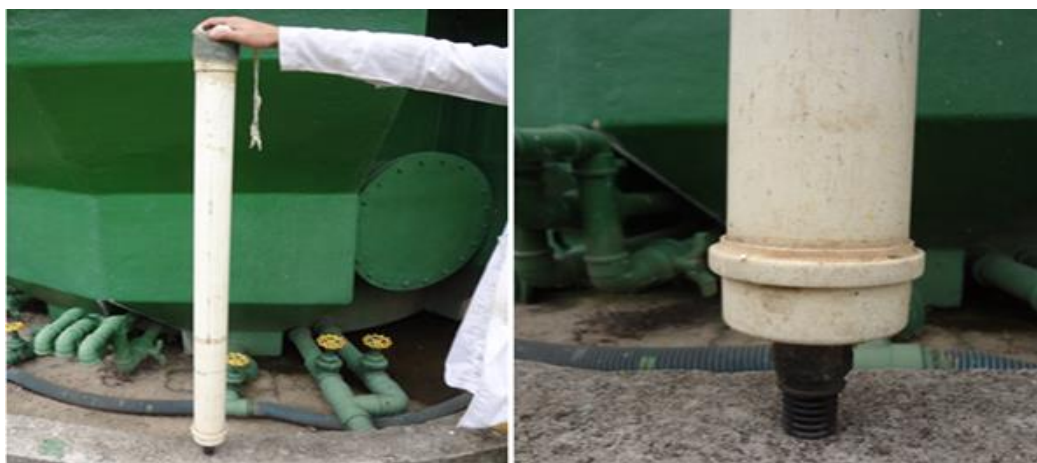
Figura 6.4: Coletor utilizado para amostragem de efluente das lagoas de polimento.
